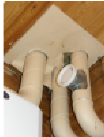
Epätiivis ilmanvaihtoputkien läpivienti yläpohjaan.
