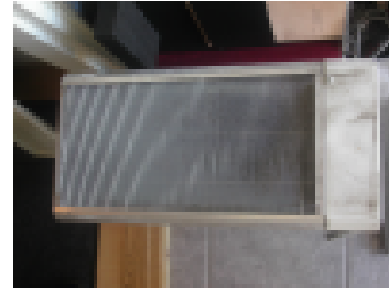
Puhdista ilmanvaihtokoneen lämmöntalteenottokeino kerran vuodessa.
