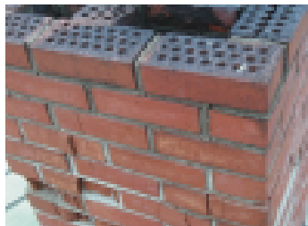
Pahasti rapautunut ja suojaamaton savupiipun yläosa.
