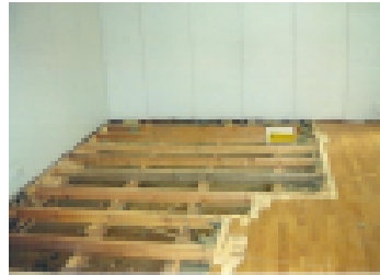
Osaksi avattua vaurioitunutta lattiarakennetta.
