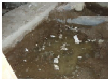
Lattia on kastunut maaperästä tulevasta kosteudesta..
