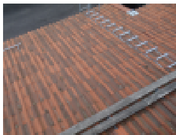
Kattovarusteiden kiinnityskohdat voivat vuotaa.
