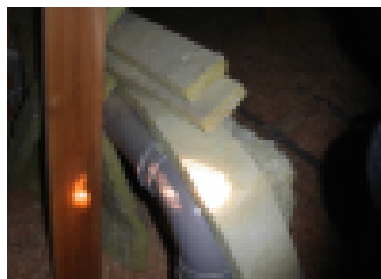
Huonosti eristetty viemärin tuuletusputki.
