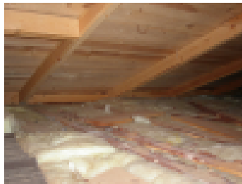
Ei tuuletusaukkoja sivuräystäillä, mutta silti vaurioitumattomalta näyttävät rakenteet.
