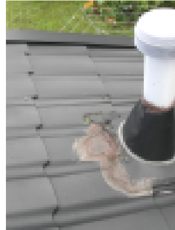
Tuuletusviemärin moneen kertaan paikkailtu läpivienti.
