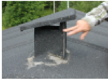
Katon harjalta toteutettu tuuletus.
