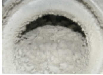
Pikaista puhdistusta vaativa ilmanvaihtoputki.
