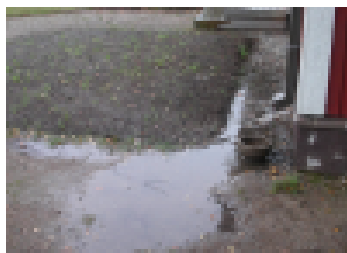
Vedenpoisto talon nurkalta ei toimi.
