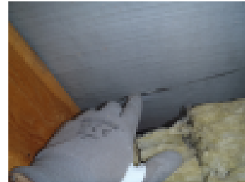
Repeämä aluskatteessa ja suoraan aluskatetta vasten asennettuja lämmöneristeitä.
