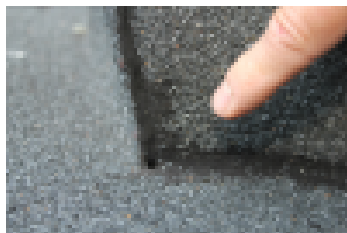
Reikä läpiviennin juuressa.
