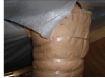
Aluskatteen epätiivis läpivienti.
