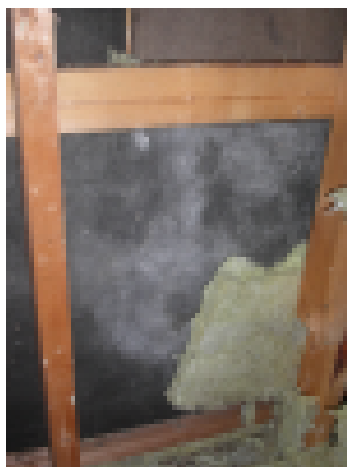
Höyrynsuluttoman rakenteen ulkopuolen vaurioita.
