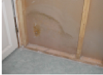
Muovimaton sauman vuotaminen pesuhuoneessa on aiheuttanut väliseinään kosteusvaurion.
