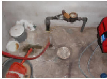
Pääsulku ja vesimittari kattilahuoneessa.
