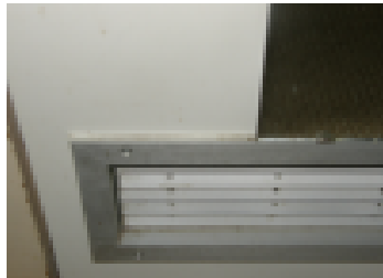
Erillinen siirtoilmasäleikkö vessan oven alareunassa.
