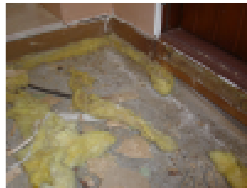
Kostunut ja vaurioitunut päältäpäin eristetty puukoolattu lattiarakenne.
