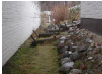
Lähekkäin rakentaminen tekee pintavesien ohjaamisen vaikeaksi.
