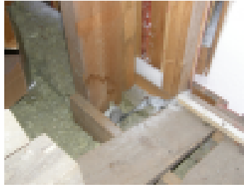
Ilmavuotokohta seinän ja katon liittymässä. Myös lunta on pyryttänyt eristeiden päälle.
