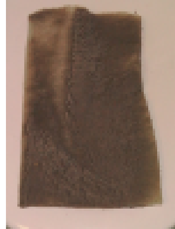
Likainen ilmanvaihtokoneen suodatin.
