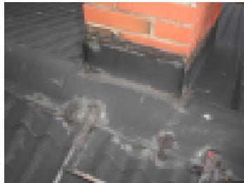
Useampaan kertaan paikattu vesikate.
