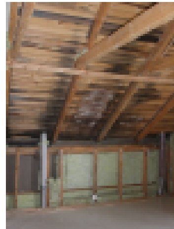
Kattovuodon ja huonon tuuletutuksen aiheuttamia vaurioita yläpohjassa.
