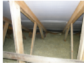
Hyvin tuulettuva yläpohjarakenne - tosin yksi tuuliohjainlevy pudonnut.
