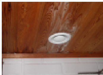
Huonosti eristetyn poistoputken venttiilistä on valunut vettä, joka on kastellut rakenteita.
