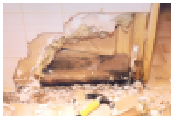
Pesuhuoneen seinän vaurio.
