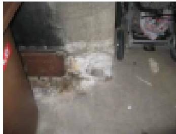
Savupiipun kosteus tiivistyy piipun juureen
