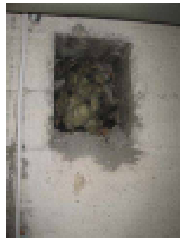
Kellarin raitisilmaventtiili on tukittu
