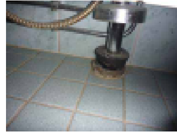
Viemärin tiiviste irronnut
