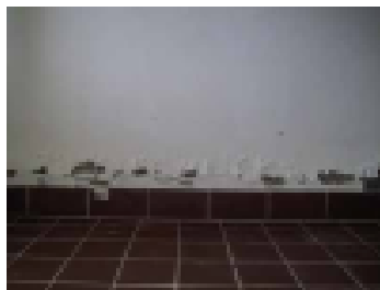
Kellarin lattian kosteus nousee seinään
