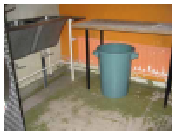
Pesutuvan lattian vedeneriste on kulunut loppuun
