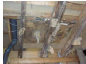
Vessan vuoto alapuolelta putkivuoto vai vesieriste pettänyt
