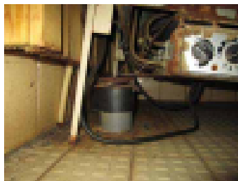
Kiuas romahtamassa lattialle
