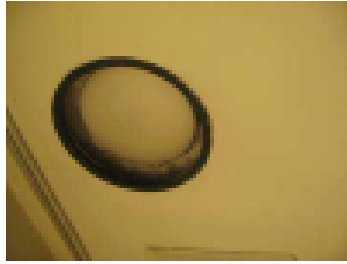
Venttiili kätkeyty rakenteisiin
