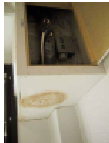
Vesi tiivistynyt rakenteissa
