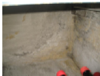
Kylmään seinään tiivistyy kosteutta
