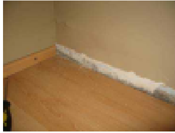
Seinä kastunut toiselta puolelta
