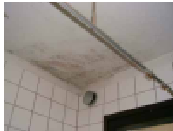
KH ilmanvaihto puutteellinen
