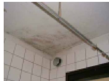
KH ilmanvaihto puutteellinen
