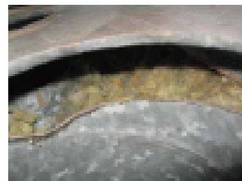
Kanavan vierestä vettä eristeisiin ja asuntoon
