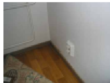
Venttiilivuodosta kosteus parketille
