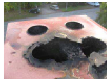
Öljykattilan savu rasittaa piippua ja peltiä
