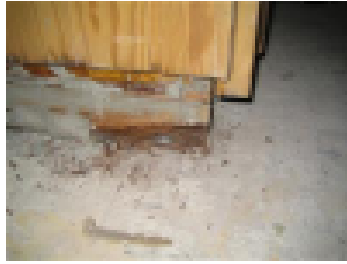
Saunan ja kylpyhuonen välinen seinä on altis vaurioille
