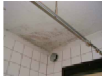
KH ilmanvaihto puutteellinen
