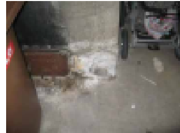
Savupiipun kosteus tiivistyy piipun juureen
