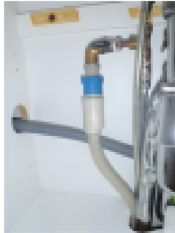
Allaskaappi ja astianpesukoneen poistoletku on tarkastettava
