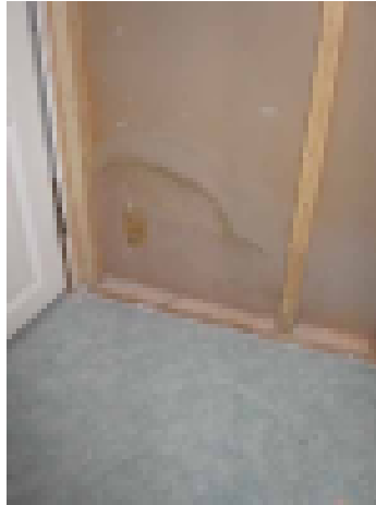
Kosteusvaurio kylpyhuoneen puisen väliseinän sisällä
