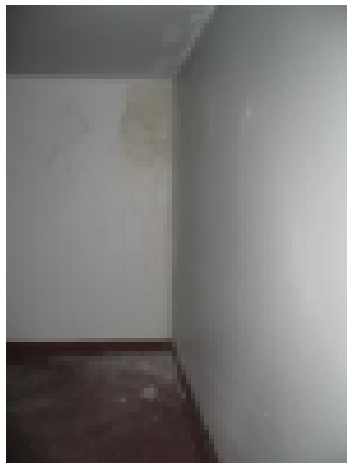
Pintojen tarkkailua on syytä tehdä säännöllisesti, uusissakin taloissa!
