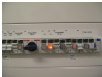
Ilmanvaihdon toimintaa on tarkkailtava huoltomiehen avustuksella
