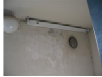
Hissikuilussakin on oma ilmanvaihto
