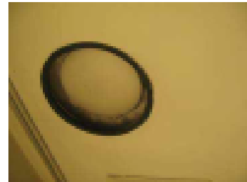
Venttiili kätkeyty rakenteisiin
