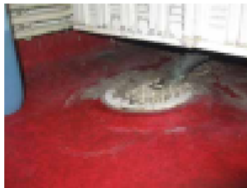
Puhdista lattiakaivo säännöllisesti
