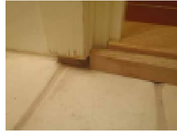
Kynnys ei ole tiivis. Vesi pääsee tulvatilanteessa kuiviin tiloihin
