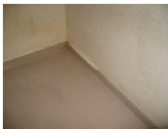
Tuulettumiin pintoihin kosteus tiivistyy ja mikrobitoiminnat alkavat
