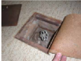
Käytöstä poistettu sulkuventtiili lattian sisällä, puuosat mikrobivaurioituneet
