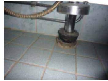
Viemärin tiiviste irronnut
