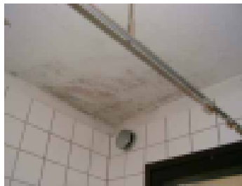
KH ilmanvaihto puutteellinen
