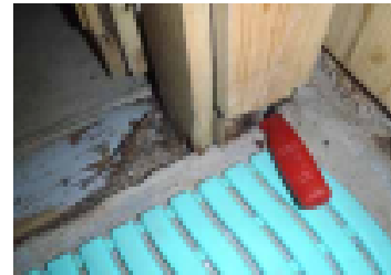
Märkätilan kynnyksen tiiveys ei ole ollut riittävä
