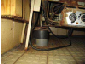
Kiuas romahtamassa lattialle
