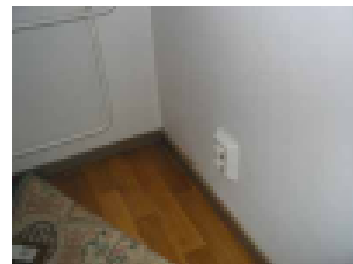
Venttiilivuodosta kosteus parketille
