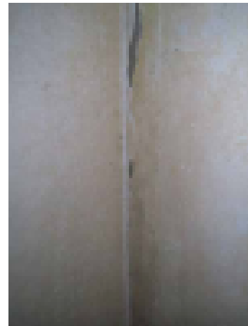
Kuivaushuoneen nurkka homeessa
