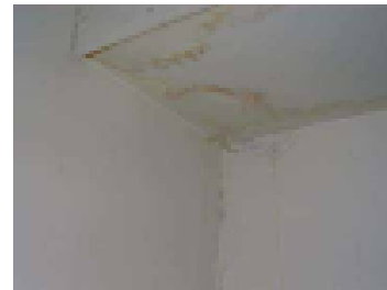
Putkista tiivistyy kosteutta
