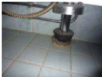
Viemäriin tiiviste irronnut
