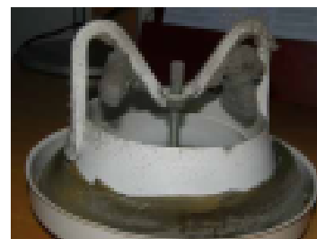
Likaiset poistoilmaventtiilit tulee puhdistaa kaksi kertaa vuodessa
