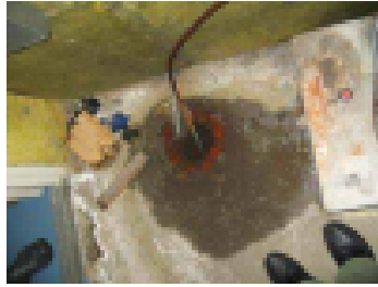
Kylmäkoneen lattiakaivo tukossa
