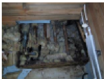
Kanaalit on yllätyksiä, ellei niiden kuntoa seurata
