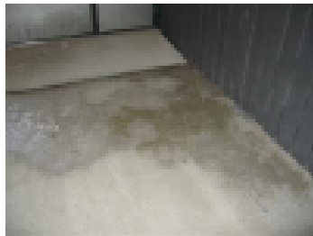
Kosteus aiheuttaa mikrobivaurion pintkään jatkuessaan
