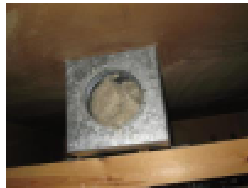
Vedon takia tukittu tuloilmakanava
