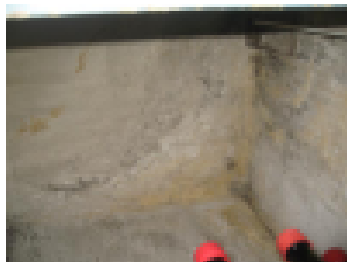
Kylmään seinään tiivistyy kosteutta
