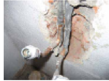
Kupariputket seinän sisällä
