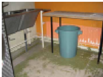
Pesutuvan lattian vedeneriste on kulunut loppuun
