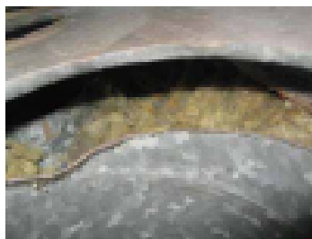
Kanavan vierestä vettä eristeisiin ja asuntoon
