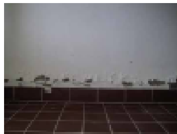
Kellarin lattian kosteus nousee seinään
