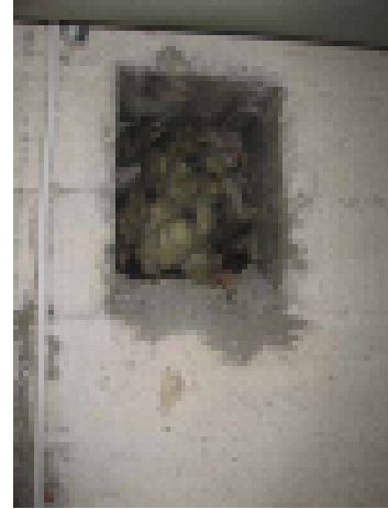
Kellarin raitisilmaventtiili on tukittu
