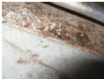
Liitos ei ole pitänyt, levy mikrobien peitossa
