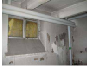
Kellarin maalit irtoaa
