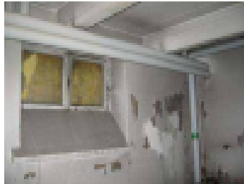
Kellarin maalit irtoaa
