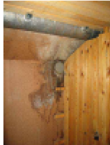
Kellarin raitisilmaventtiili ja kosteusvaurio
