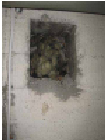
Kellarin raitisilmaventtiili on tukittu
