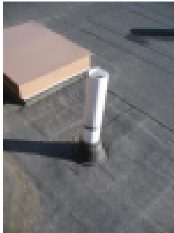
Saumat ja liittymät kannattaa tarkastaa
