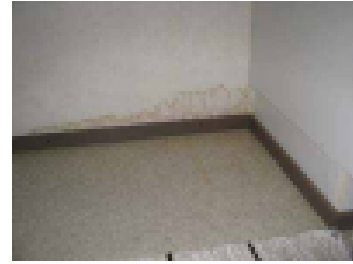
Seinä kastunut mh
