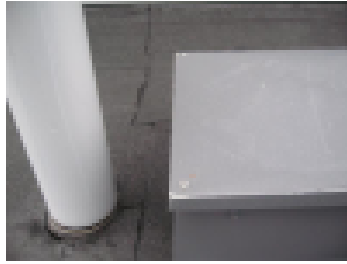
Putkien ja liittymien juuret ovat vuotopaikkoja
