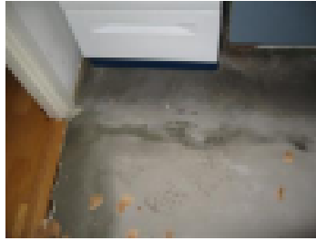
Alapohjasta nousee kosteutta
