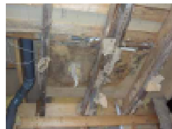
Vessan vuoto alapuolelta putkivuoto vai vesieriste pettänyt
