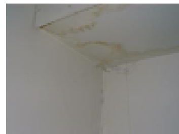
Vuodot ja tiivistyminen aiheuttavat vaurioita ja pilaavat sisäilmaa
