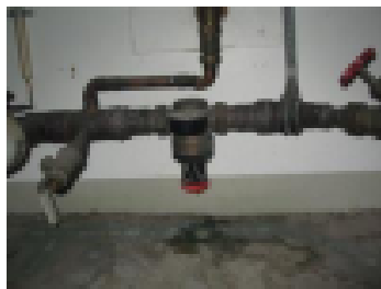
Kylmäputket tiivistävät kosteutta vedeksi
