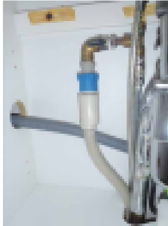
Allaskaapissa oleva pesukoneen liitäntä. Tiiveys tulee tarkastaa
