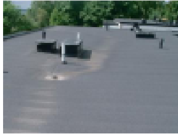
Lammikoituminen rasittaa katetta
