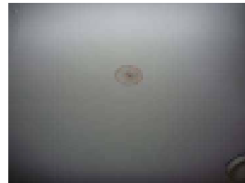
Kosteusvaurio näkyy alakerran katossa
