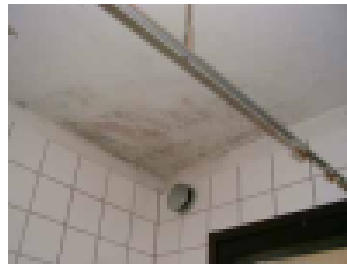
KH ilmanvaihto puutteellinen
