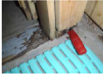
Märkätilan kynnyksen tiiveys ei ole ollut riittävä
