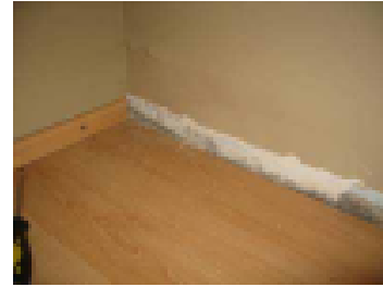
Seinä kastunut toiselta puolelta
