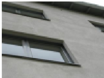
Ikkunan yläpuolikin tulee olla tiivis
