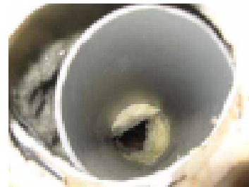
Putken vierestä ilmaa rakenteisiin
