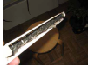
korvausilmaventtiili pitää puhdistaa
