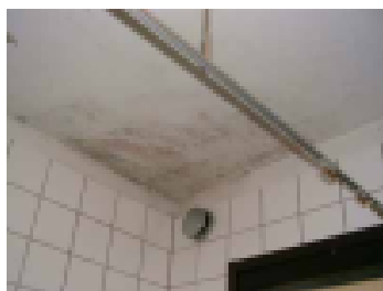
KH ilmanvaihto puutteellinen
