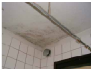
KH ilmanvaihto puutteellinen
