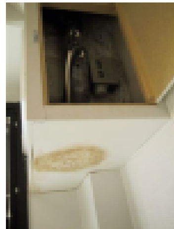
Vuotojäljet koteloidissa ovat aina tarkastuksen paikka
