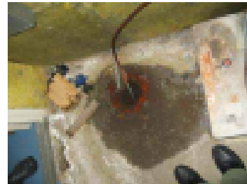
Kylmäkoneen lattiakaivo tukossa
