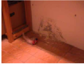
Kellarin seinään nousee kosteutta
