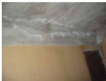
Kosteutta katon rajassa, ilmenee kalkin irtoamisena
