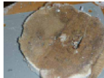
Seinän levytys kastunut
