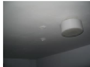
Lattian vuodot näkyvät alapuolella
