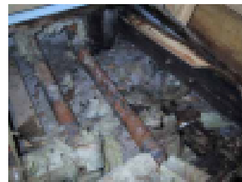
Lattian alta vesivuoto
