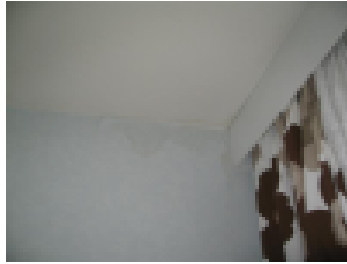
Yläpohjan vauriot ilmenevät asuintiloissa
