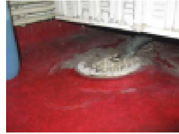
Puhdista lattiakaivo säännöllisesti
