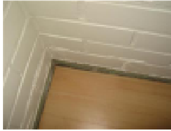
Betonilaatta kutistuu ja avaa raon seinän viereen
