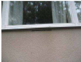
Rakovihtiili ikkunan alla
