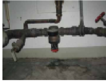
Käyttöveteen on asennettu paineen tasaaja säästämään putkistoa kovilta paineiskuilta ja turhalta syöpmiseltä
