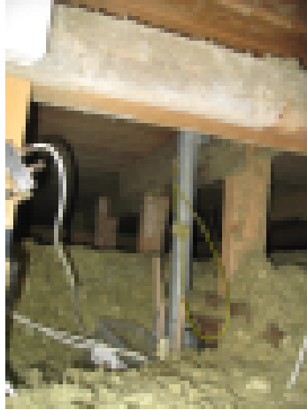
Alapuolinen tuuletuspuute lämmittää kattopintaa
