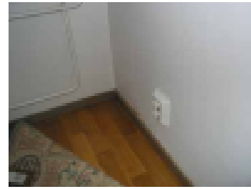
Venttiilivuodosta kosteus parketille
