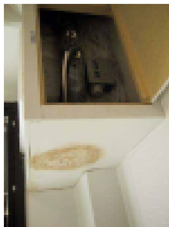
Vesi tiivistynyt rakenteissa
