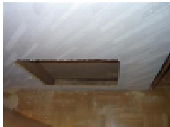
kuivan tilan puolelta avaus ei vaurioita mahdollisesti ehjää vedeneristettä
