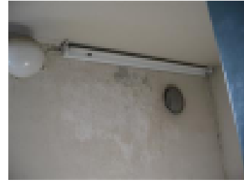
Hissikuilussakin on oma ilmanvaihto
