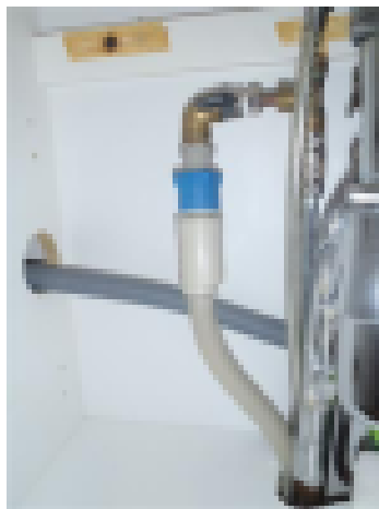
Allaskaappi ja astianpesukoneen poistoletku on tarkastettava
