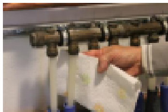
Vuotojen tarkastus kalusteiden sisällä oleviin liitoksiin
