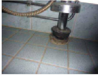
Viemärin tiiviste irronnut
