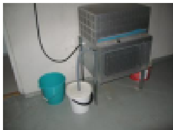
Lisäveden valuttaminen lattialle on turhaa
