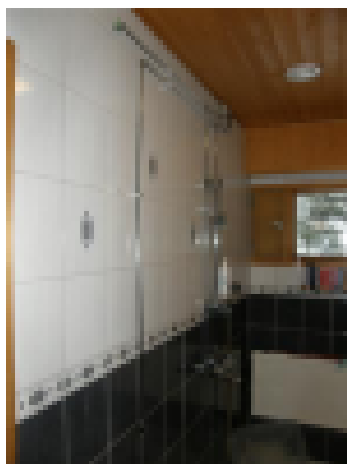
Putket tuodaan yläkautta
