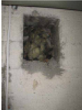
Kellarin raitisilmaventtiili on tukittu
