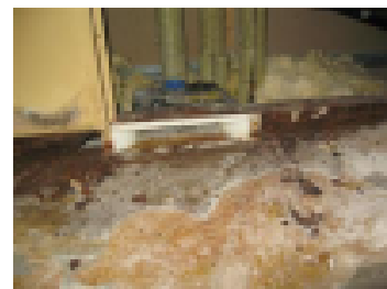
Kaivon vierestä vesi pääsee elementtirakenteeseen
