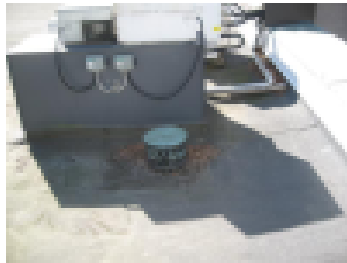
suuri siivilä kattokaivon ympärillä
