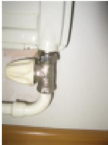
Pelkät venttiilit toimivat, jos verkosto on oikein tasapainossa
