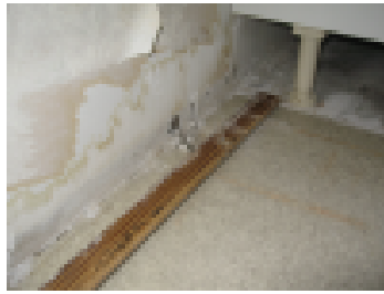
Syyt poistetaan, ennen pintakorjauksia
