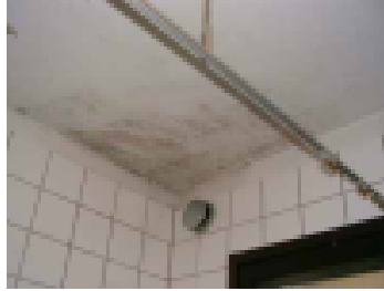
KH ilmanvaihto puutteellinen
