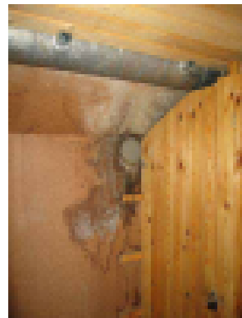
Kellarin raitisilmaventiili ja kosteusvaurio
