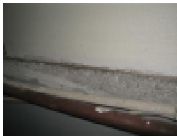
Kuivan tilan puolelta voi näkyä vaurio
