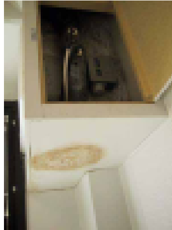
Vesi tiivistynyt rakenteissa
