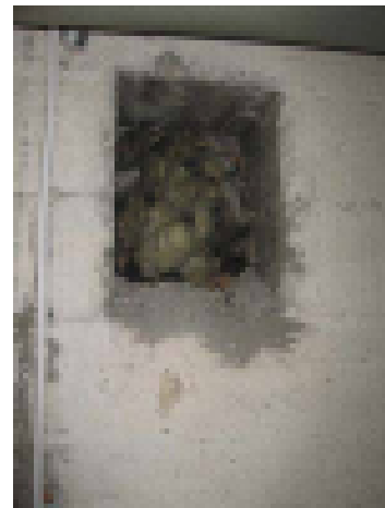
Kellarin raitisilmaventtiili on tukittu
