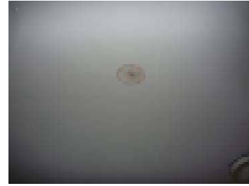
Kosteusvaurio näkyy alakerran katossa
