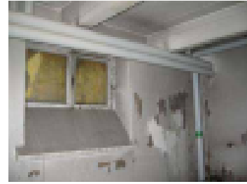
Kellarin maalit irtoaa
