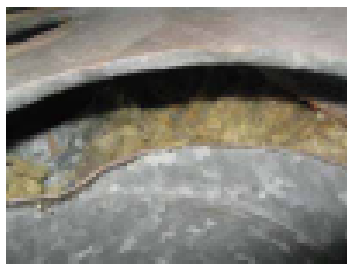
Kanavan vierestä vettä eristeisiin ja asuntoon
