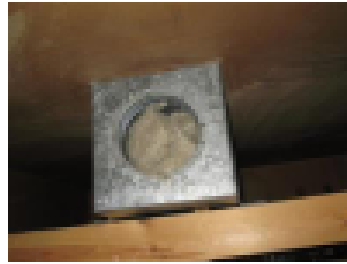
Vedon takia tukittu tuloilmakanava
