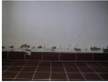
Kellarin lattian kosteus nousee seinään
