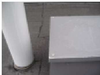
Putkien ja liittymien juuret ovat vuotopaikkoja
