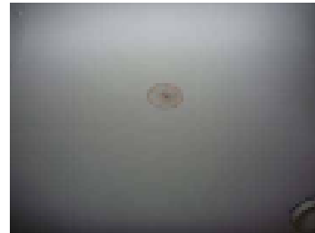
Kosteusvaurio näkyy alakerran katossa
