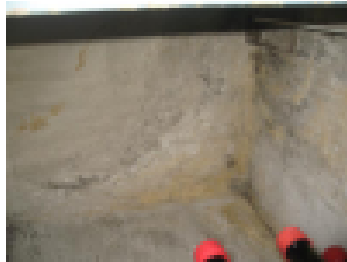
Kylmään seinään tiivistyy kosteutta
