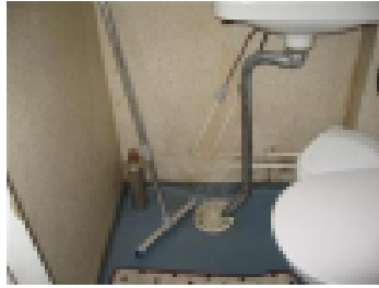
Vanha muovimatto ei ole hyvä vedeneriste
