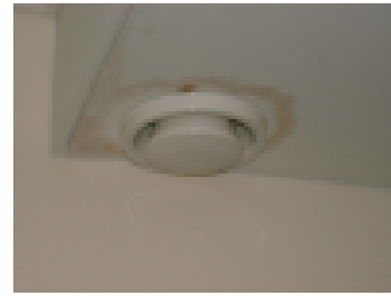
Vuotoa putken ympärillä
