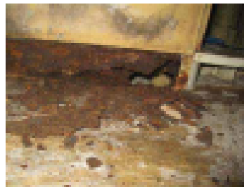
Elementtiseinän alapää on ruostunut
