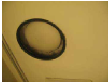
Venttiili kätkeyty rakenteisiin
