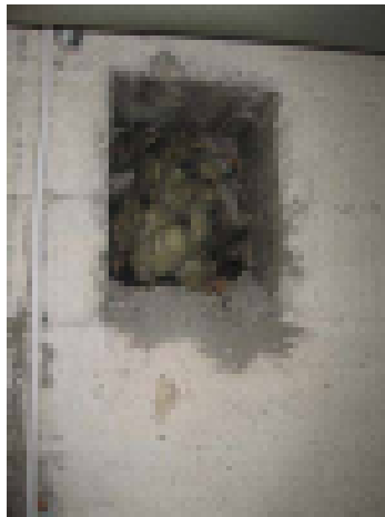
Kellarin raitisilmaventtiili on tukittu
