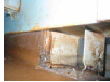
Seinäkaivosta matto on irronnut
