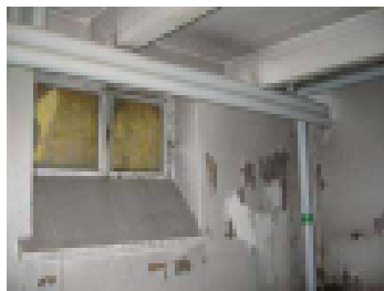
Kellarin maalit irtoaa
