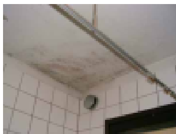
KH ilmanvaihto puutteellinen
