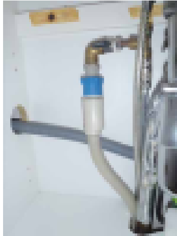
Allaskaapissa oleva pesukoneen liitäntä. Tiiveys tulee tarkastaa
