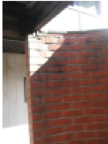
Rännivuodot ilmenevät värimuutoksina
