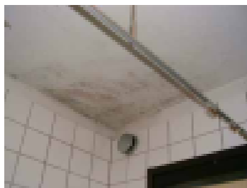
KH ilmanvaihto puutteellinen
