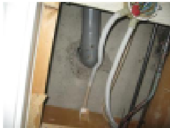
Läpiviennit tulee tarkastaa avaamalla alaslaskuja
