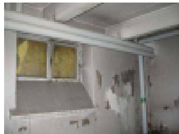
Kellarin maalit irtoaa
