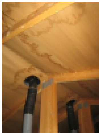
Tummentumat rakenteissa osoittavat vuotoja
