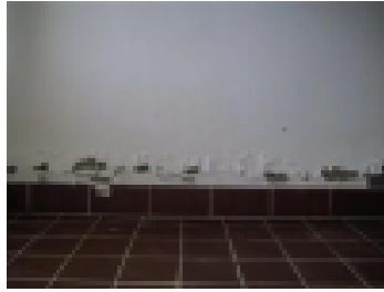
Kalkki ja maalin irtoamiset ilmaisevat kosteutta rakenteissa
