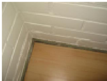
BEtonilaatta kutistuu ja avaa raon seinän viereen
