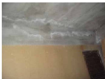
Kosteutta katon rajassa, ilmenee kalkin irtoamisena
