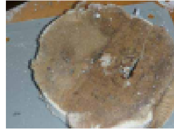
Seinän levytys kastunut
