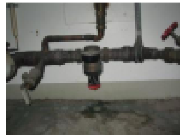
Vuotojen ilmoitus kannattaa, estät pahemmat vauriot
