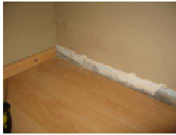
Seinä kastunut toiselta puolelta
