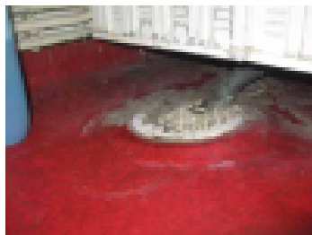
Puhdista lattiakaivo säännöllisesti
