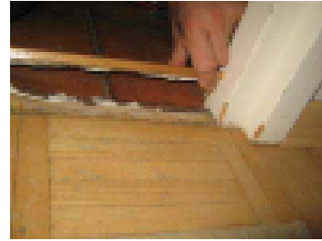
KH ovirako ja tulvakynnys puuttuu
