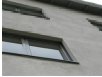
Ikkunan yläpuolikin tulee olla tiivis
