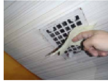
Pesuhuoneen katon poistosäleikössä ei pysy edes paperi. Poistoilmahormi voi olla tukossa tai tilaan ei tule korvausilmaa riittävästi
