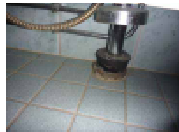
Viemärin tiiviste irronnut
