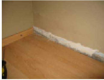
Seinä kastunut toiselta puolelta
