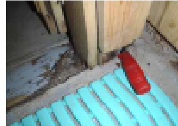
Märkätilan kynnyksen tiiveys ei ole ollut riittävä
