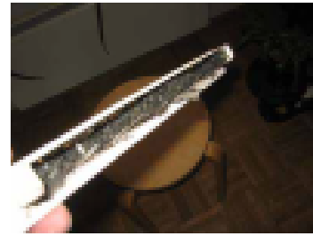
korvausilmaventtiili pitää puhdistaa
