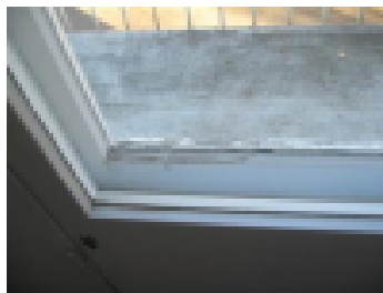
Tuuletusparvekkeiden kuntoa tulee seurata
