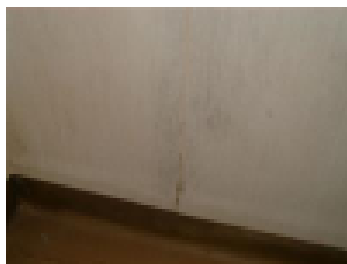
Vuotavat saumat ovat vaurion alku
