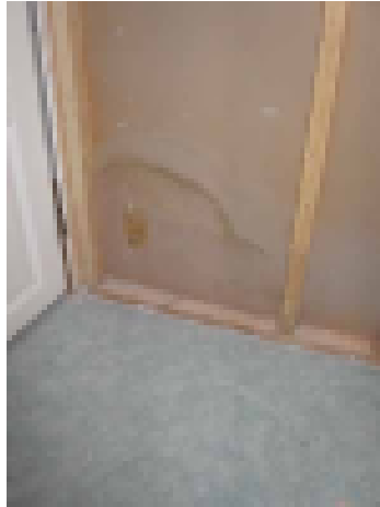
Kosteusvaurio kylpyhuoneen puisen väliseinän sisällä
