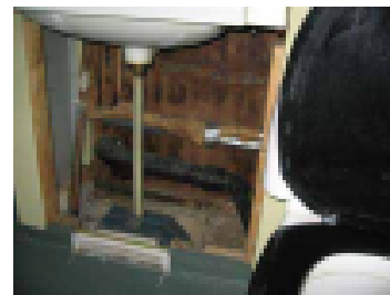
Seinän sisällä kosteutta
