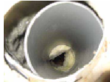
Putken vierestä ilmaa rakenteisiin
