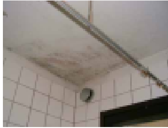
KH ilmanvaihto puutteellinen
