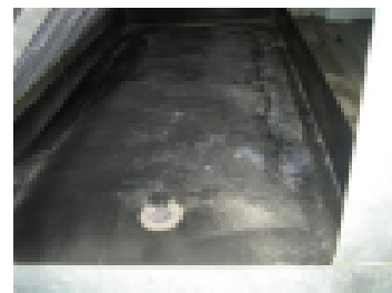
Kosteus pääsee sisään ja kastelee kanavan mikrobialustaksi
