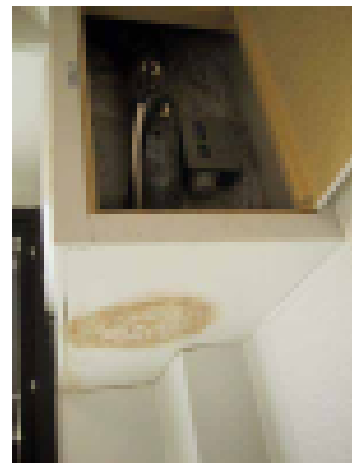
Vesi tiivistynyt rakenteissa
