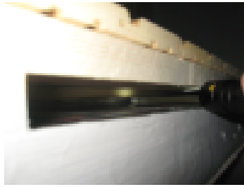
Tuuletusrako panelin takana
