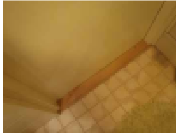
Kylpyhuoneen oven alta puuttuu parin senttimetrin korkuinen rako, josta korvausilma siirtyy kylpyhuoneeseen päin
