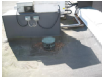
suuri siivilä kattokaivon ympärillä
