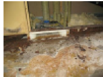
Kaivon vierestä vesi pääsee elementtirakenteeseen
