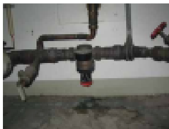
Käyttöveteen on asennettu paineen tasaaja säästämään putkistoa kovilta paineiskuilta ja turhalta syöpymiseltä
