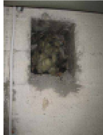
Kellarin raitisilmaventtiili on tukittu
