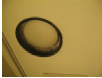
Venttiilien kuntoa tulee seurata
