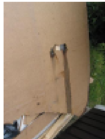
Tiivistymisen jälkiä levyn takana
