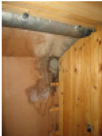
Kylmäkellarin turhasta tuloventtiilistä tiivistyy kosteutta
