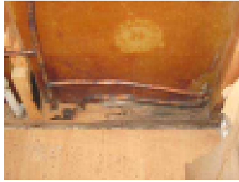
KH seinään on tiivistynyt kosteutta
