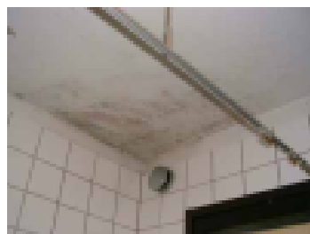
KH ilmanvaihto puutteellinen
