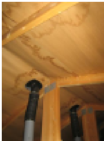
Tummentumat rakenteissa osoittavat vuotoja
