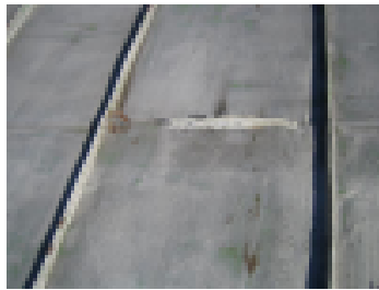
Katon mekaanisia vaurioita, tarkastus vain suojaruustein
