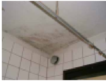
KH ilmanvaihto puutteellinen
