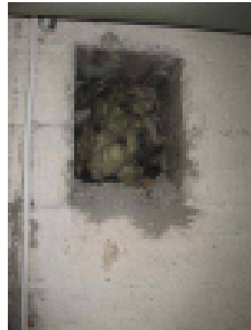
Kellarin räitisilmaventtiili on tukittu
