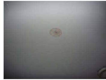
Kosteusvaurio näkyy alakerran katossa
