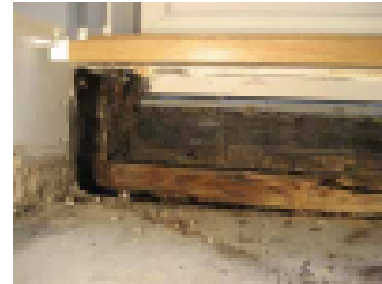
Puurakenteita jäänyt kaksoislattian alle ja kastuneet vuotovesistä
