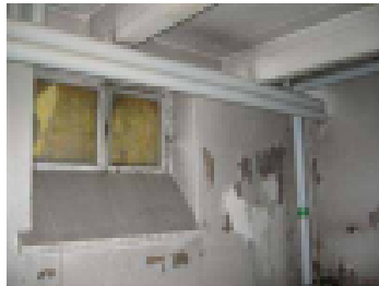
Kellarin maalit irtoaa
