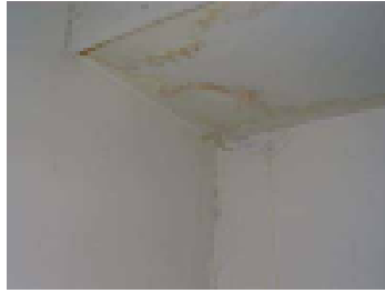
Putkista tiivistyy kosteutta
