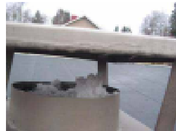
Poistoilma tukittu katolla
