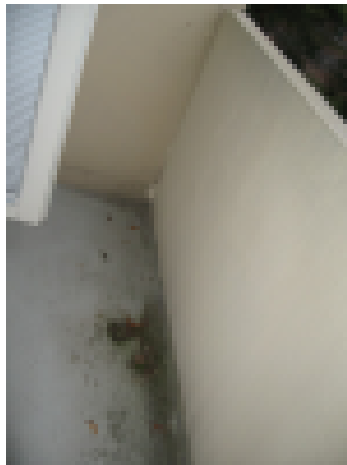
Kaiteen liittymät ja vedenpoisto usein puutteelliset
