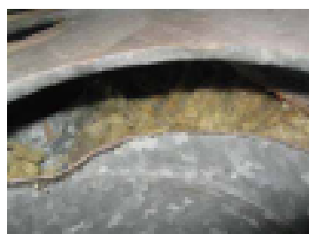
Kanavan vierestä vettä eristeisiin ja asuntoon
