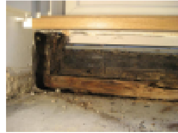
märkätilan seinän rakenne ja vaurio
