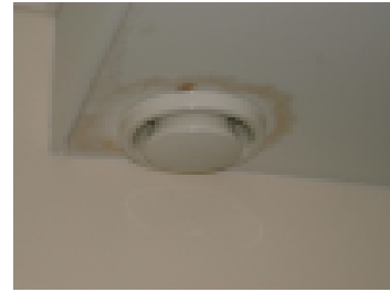
Vuotoa putken ympärillä
