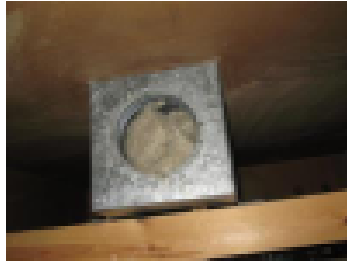
Vedon takia tukittu tuloilmakanava
