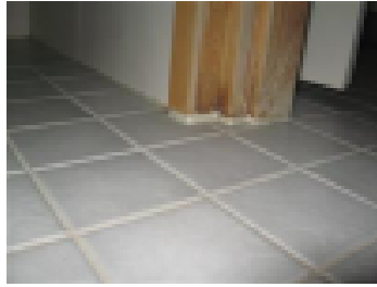
Seura laatoituksen kuntoa
