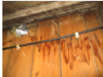
Kosteusvaurion jälkiä yläpohjassa
