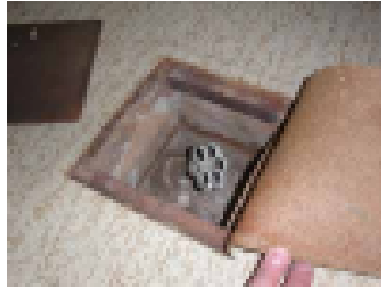
Käytöstä poistettu sulkuventtiili lattian sisällä, puuosat mikrobivaurioituneet
