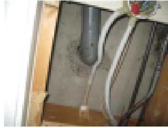
Tarkastusluukut on yleensä merkattu
