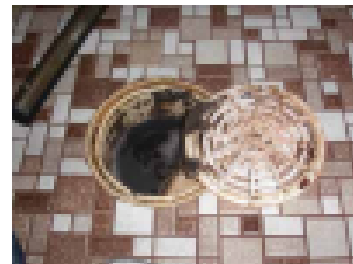
Lattiakaivot tulee puhdistaa säännöllisesti
