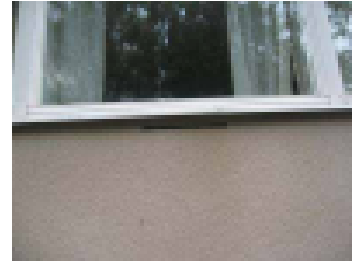
Rakovihti ikkunan alla
