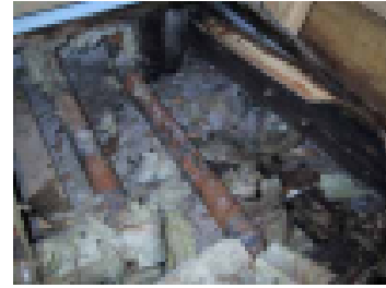
Lattian alta vesivuoto
