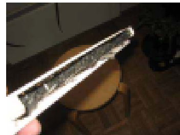
korvausilmaventtiili pitää puhdistaa
