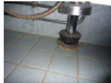
Viemäriin tiiviste irronnut
