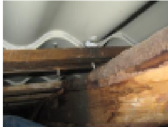
Aluskate puuttuu ja tuuletus
