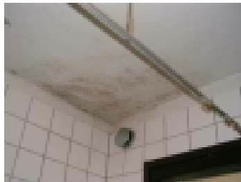
Puutteellinen ilmanvaihto aiheuttaa kosteusvaurion ja pahentaa vaikutuksia
