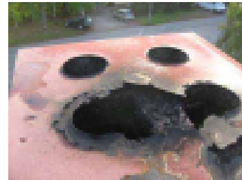
Öljykattilan savu rasittaa piippua ja peltiä
