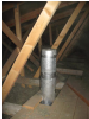
Putket eivät saa loppua yläpohjaan
