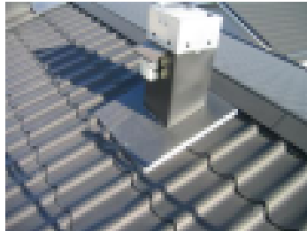
Peltikaton liittymät tarkastettava
