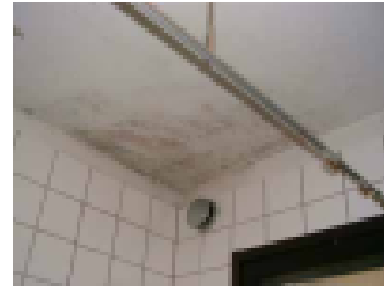
KH ilmanvaihto puutteellinen
