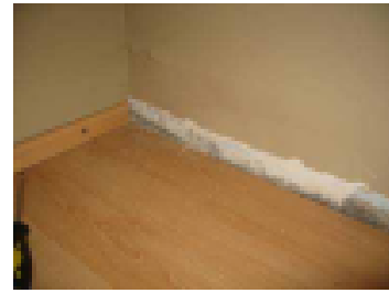
Seinä kastunut toiselta puolelta
