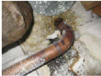
Putki kondensoinut vettä
