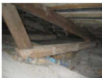
Kannakkeiden päät tulee tarkastaa
