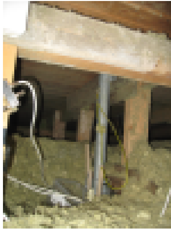
Alapuolinen tuuletuspuute lämmittää kattopintaa
