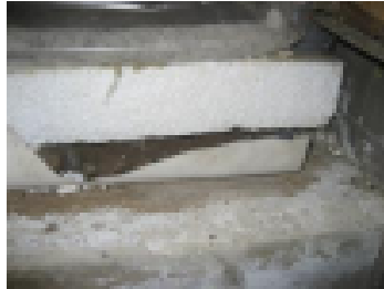
Lattian rakenne voi olla yllättävä
