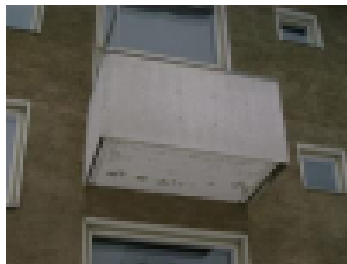
Levyjen takana rakenteet terästä, tarkasta
