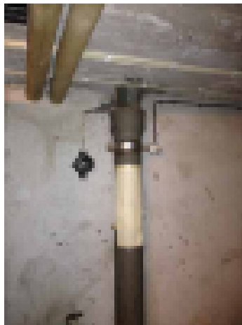
Valurautaviemäriä jo paikattu muovilla
