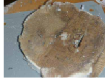
Seinän levytys kastunut
