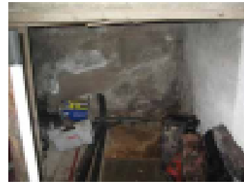
Sokkelin vedeneristys on pettänyt ja kosteutta tulee sokkelin läpi
