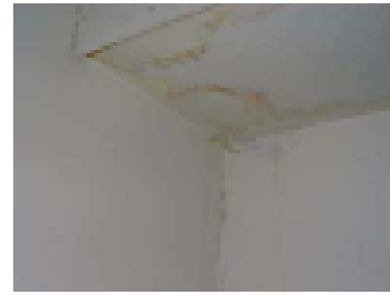
Putkista tiivistyy kosteutta
