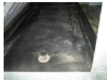
Kosteus pääsee sisään ja kastelee kanavan mikrobialustaksi
