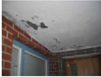
Parvekkeen alapinta kunnostettava
