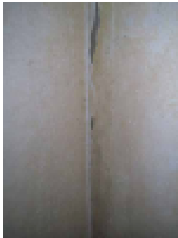
Kuivaushuoneen nurkka homeessa
