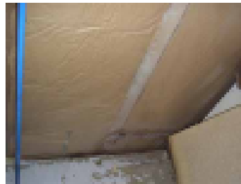
Seinän levytys on vaurioitunut kuivaltakin puolelta
