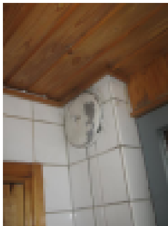
Tarkista venttiilit ja ilmavirtauksen suunta
