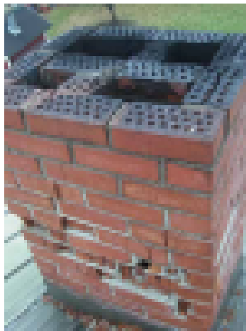
Hormit ovat todennäköisesti tukkeessa, koska piippukin on näin huonossa kunnossa
