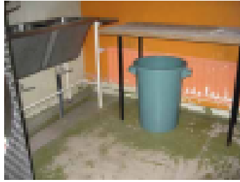
Pesutuvan lattian vedeneriste on kulunut loppuun
