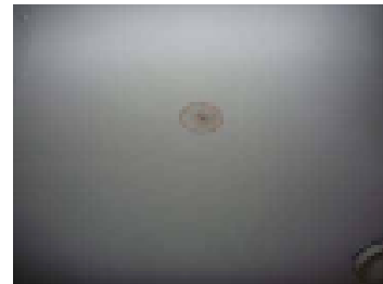
Kosteusvaurio näkyy alakerran katossa
