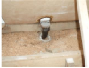
Altaan liitos on vuotanut
