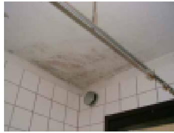
KH ilmanvaihto puutteellinen
