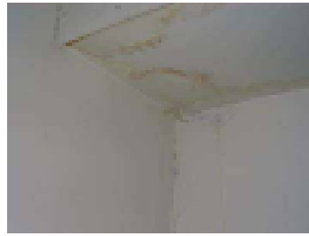
Putkista tiivistyy kosteutta
