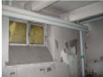
Kellarin maalit irtoaa
