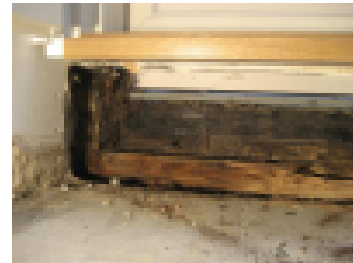
märkätilan seinän rakenne ja vaurio
