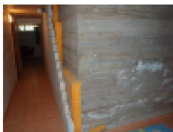
Kalkki ilmaisee kosteutta seinässä
