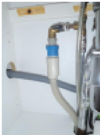
Allaskaapin liitokset tarkastettava. Apk:n poiston mekaaninen kiinnitys
