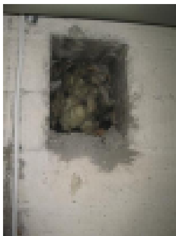
Vedon takia tukittuja poistoventtiileitä
