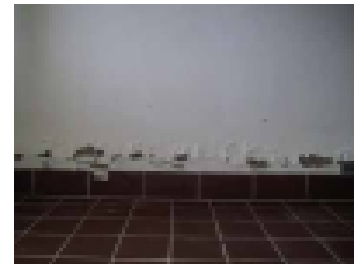
Kellarin lattian kosteus nousee seinään
