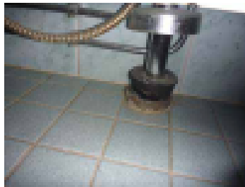
Viemäriin tiiviste irronnut
