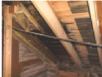
Tuuletuksen puutetta, rakenteet kostuvat ja vaurioituvat
