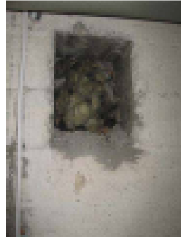
Kellarin raitisilmaventtiili on tukittu
