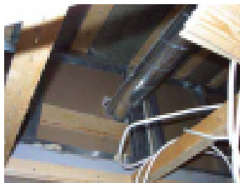
Läpiviennit eivät tiiviit
