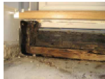
Puurakenteita jäänyt kaksoislattian alle ja kastuneet vuotovesistä
