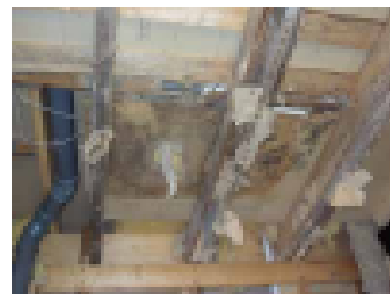
Vessan vuoto alapuolelta putkivuoto vai vesieriste pettänyt
