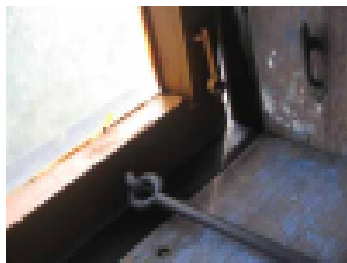
Ikkunat vuotavat ja kondensoivat kosteutta
