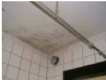
KH ilmanvaihto puutteellinen
