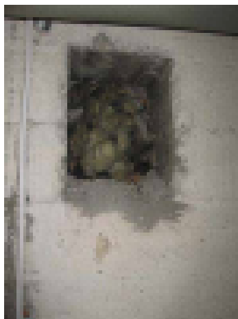
Kellarin raitisilmaventtiili on tukittu
