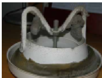
Likaiset poistoilmaventtiilit tulee puhdistaa kaksi kertaa vuodessa
