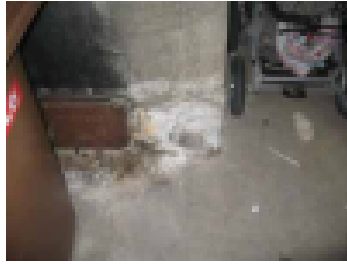
Savupiipun kosteus tiivistyy piipun juureen
