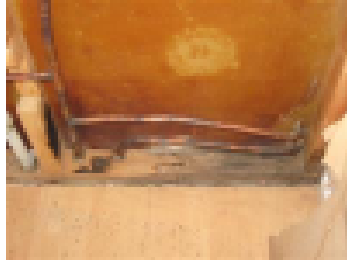
Eristämättömät putket kostuttavat seinärakenteita
