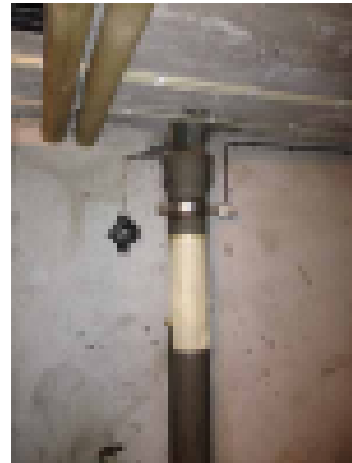
Valurautaviemäriä jo paikattu muovilla
