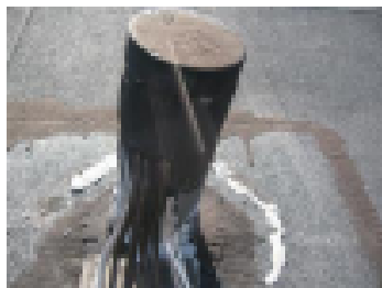
Läpiviennit katossa aina riskejä
