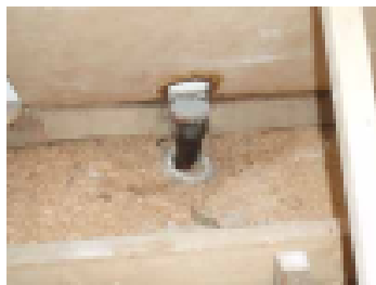
Keittiön tiskialtaan viemäri on vuotanut
