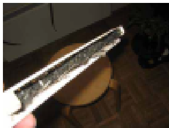
korvausilmaventtiili pitää puhdistaa
