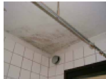
KH ilmanvaihto puutteellinen
