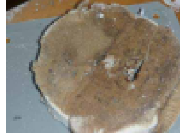
Seinän levytys kastunut
