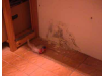
Kellarin seinään nousee kosteutta
