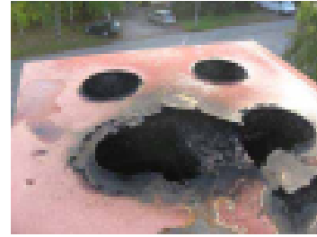
Öljykattilan savu rasittaa piippua ja peltiä
