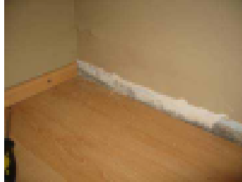
Seinä kastunut toiselta puolelta
