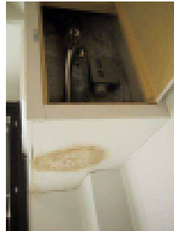
Vesi tiivistynyt rakenteissa
