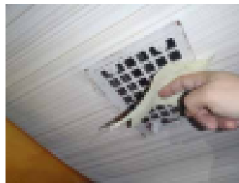
Pesuhuoneen katon poistosäleikössä ei pysy edes paperi. Poistoilmahormi voi olla tukossa tai tilaan ei tule korvausilmaa riittävästi
