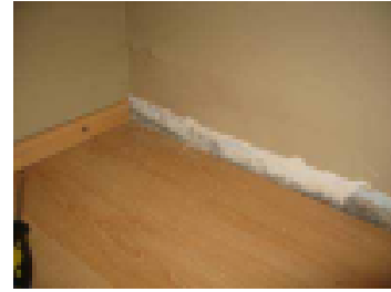
Seinä kastunut toiselta puolelta
