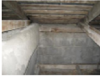
Vuotojälkiä tuulee seurata ja tutkia syyt
