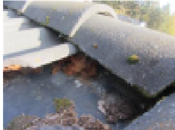
Liitymät usein vuotokohtia
