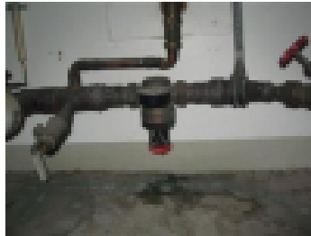
Vuotojälkiä tuulee seurata ja tutkia syyt
