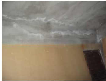
Kosteutta katon rajassa, ilmenee kalkin irtoamisena
