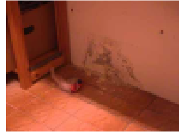
Kellarin seinään nousee kosteutta
