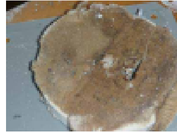
Seinän levytyks kastunut
