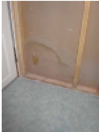
Muovimaton sauman vuotaminen pesuhuoneessa on aiheuttanut väliseinään kosteusvaurion
