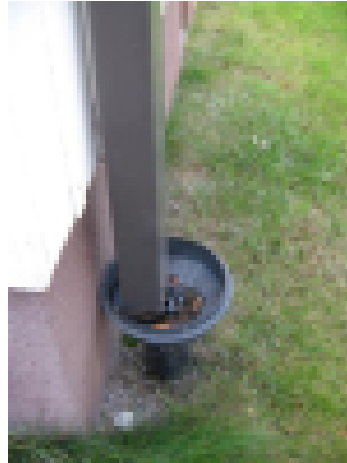
Sadevedet ohjataan omiin kaivoihinsa
