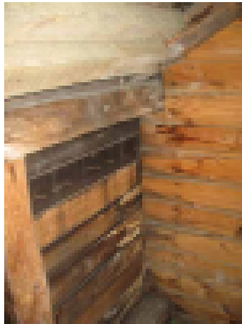
Kattoon tiivistyy kosteutta ja se valuu alakerran huoneisiin
