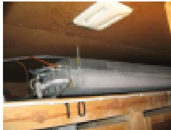
Jäähdytyspatteri levittää kylmää ilmaa tiivistymään rakenteisiin
