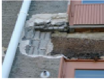
Osakorjauksia pitää harkita tarkoin. Pudonnut parveke
