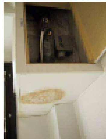
Vesi tiivistynyt rakenteissa
