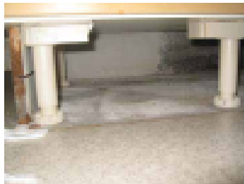
80-luvulla korjatun kellariseinän kosteusvaurio
