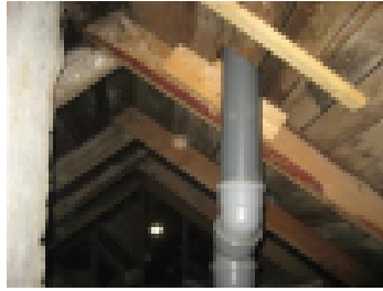
Hajuhaittojen syy pakkasella, jäätynyt hajuputki vintillä
