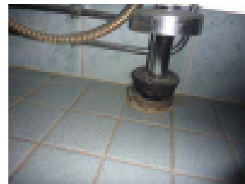
Viemärin tiiviste irronnut
