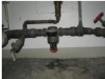
Vanhat korjatut vuotojäljet pitää poistaa
