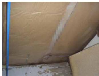
Seinän levytys on vaurioitunut kuivaltakin puolelta
