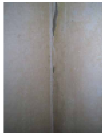
Kuivaushuoneen nurkka homeessa
