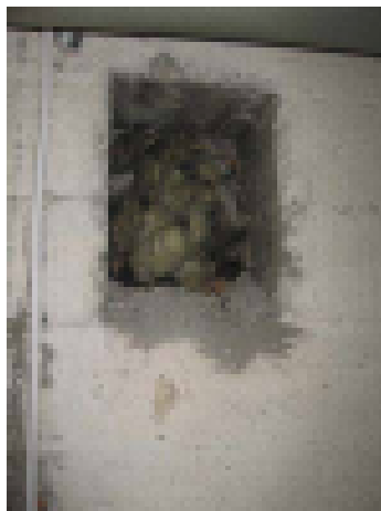
Kellarin raitisilmaventtiili on tukittu
