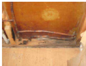
KH seinään on tiivistynyt kosteutta
