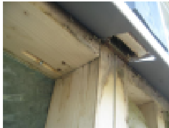
Vuotokohdasta vaurio alkaa
