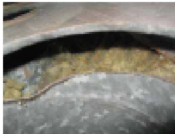
Kanavan vierestä vettä eristeisiin ja asuntoon
