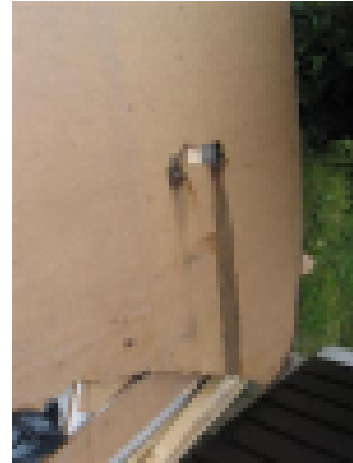
Tiivistymisen jälkeä levyn takana
