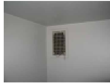
Keittiön poistoilmaritilä tukkeutumassa
