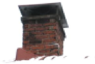
Vauriot piipussa ja läpiviennissä
