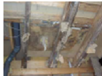
Vessan vuoto alapuolelta putkivuoto vai vesieriste pettänyt
