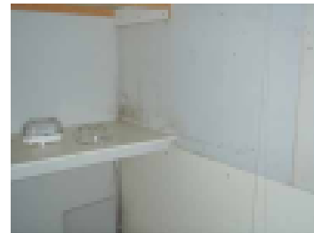
Kellarikomeroissa ilmanvaihto ei toimi ja kosteus tiivistyy rakenteisiin
