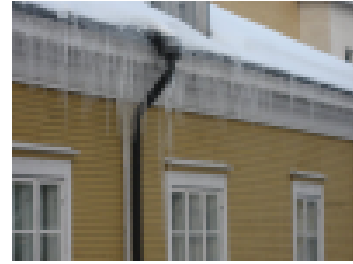
Yläpohjassa voimakas lämpövuoto
