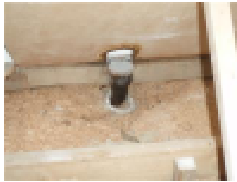
Altaan liitos on vuotanut
