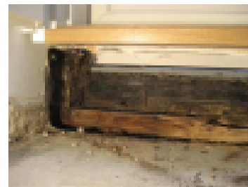
märkätilan seinän rakenne ja vaurio
