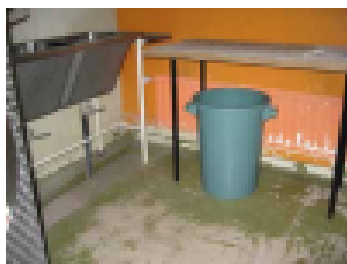
Pesutuvan lattian vedeneriste on kulunut loppuun
