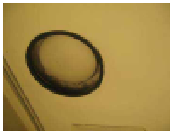
Venttiili kätkeyty rakenteisiin
