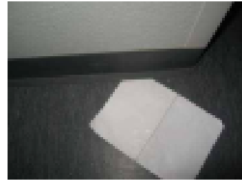
Jalkalistan alle pääsee vesi
