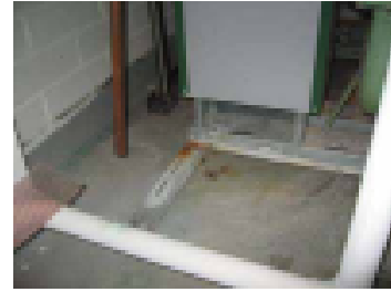
Vuotojälkiä vaihtimen alla
