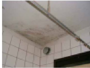
KH ilmanvaihto puutteellinen
