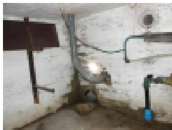
Seinän lävistävät putket usein vuotavat ulkoa vettä kellarin
