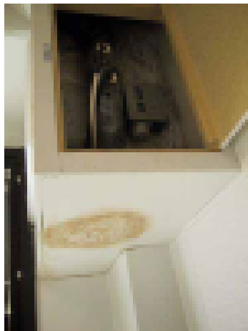
Vesi tiivistynyt rakenteissa
