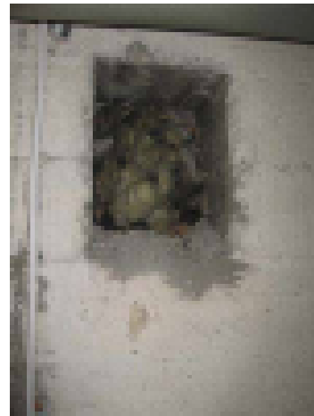
Kellarin raitisilmaventtiili on tukittu
