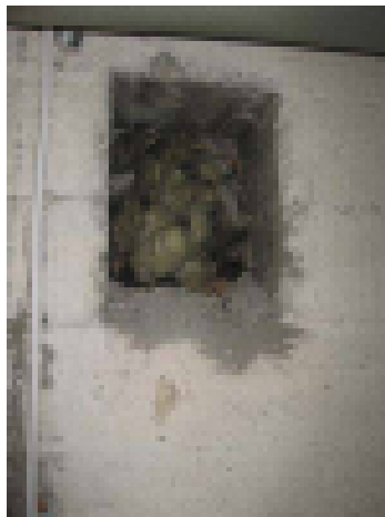
Kellarin raitisilmaventtiili on tukittu
