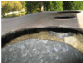
Kanavan päästä vettä eristeisiin
