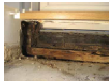
Puurakenteita jäänyt kaksoislattian alle ja kastuneet vuotovesistä
