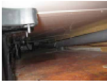
Viemäri kalusteen sokkelissa
