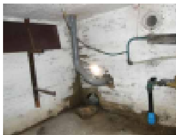
Seinän lävistävät putket usein vuotavat ulkoa vettä kellariin
