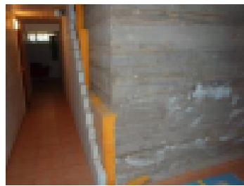
Kalkki ilmaisee kosteutta seinässä
