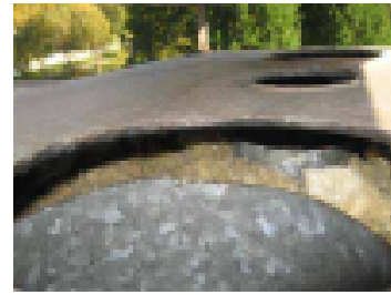
Kanavan päästä vettä eristeisiin
