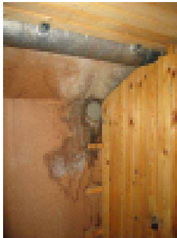
Kellarin raitisilmaventtiili ja kosteusvaurio
