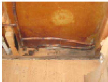
KH seinään on tiivistynyt kosteutta
