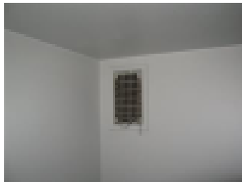
Ritilät ja venttiilit pitää puhdistaa
