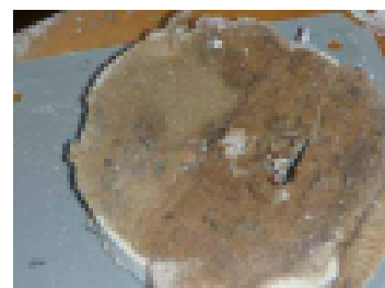
Seinän levytys kastunut
