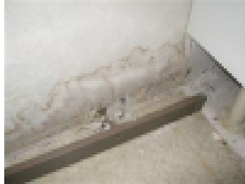
Kosteusvaurio näkyy usein toisella puolella märkätilan seinää
