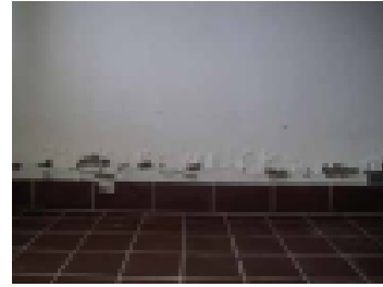
Kellarin lattian kosteus nousee seinään
