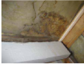
Vesivuotoa levytyksen alla
