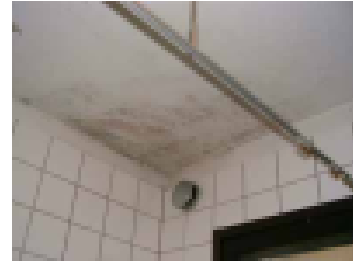
KH ilmanvaihto puutteellinen
