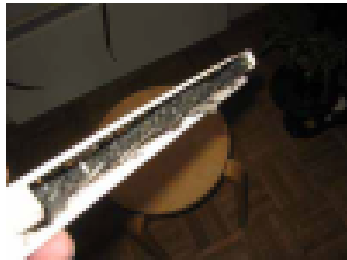
korvausilmaventtiili pitää puhdistaa
