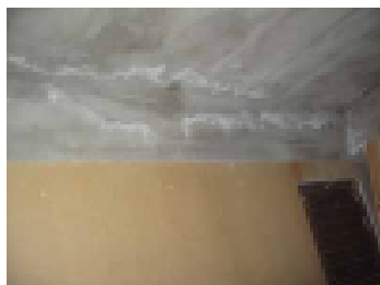
Kosteutta katon rajassa, ilmenee kalkin irtoamisena
