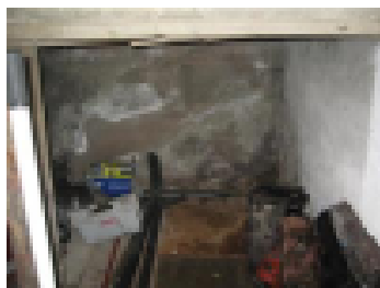
Varastot usein kostuneita ulkopuolisesta vedestä
