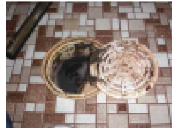
Lattiakaivot tulee puhdistaa säännöllisesti
