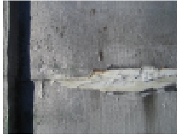
Vauriokohtia ja ruostetta
