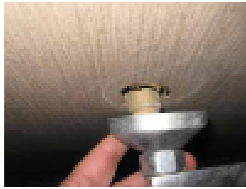
Putken läpivienti ei ole tiivis
