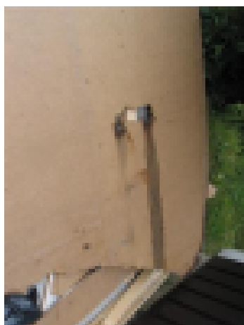
Vuotojälki purettuna kh seinälevyssä
