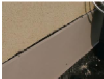
Liittymäpellien yläosa pitää olla tiivis, ei pelkällä kitillä tiivistetty
