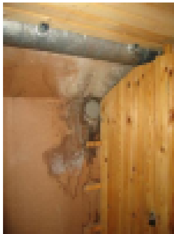
Usein kosteudet näkyy selvästi värimuutoksina
