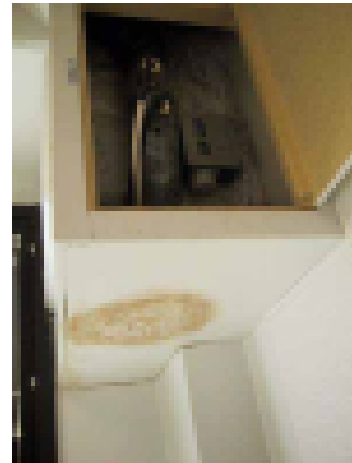
Vesi tiivistynyt rakenteissa
