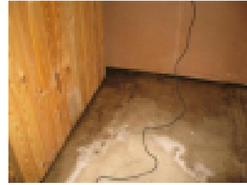
Kosteus varastojen lattialle saattaa tulla viereisen tilan poistovesistä
