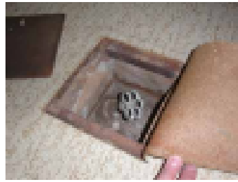
Käytöstä poistettu sulkuventtiili lattian sisällä, puuosat mikrobivaurioituneet
