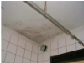
Puutteellinen ilmanvaihto aiheuttaa kosteusvaurion ja pahentaa vaikutuksia
