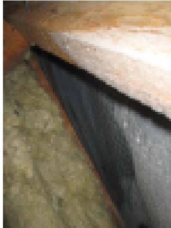
Tuuletustilassa on huono tuuletus ja aluskate jäätyy
