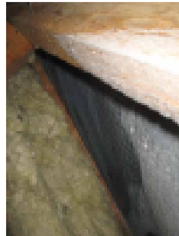
Tuuletustilassa on huono tuuletus ja aluskate jäätyy
