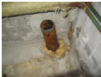
Vanhoja putkiapitkin ilma kulkee kyllä
