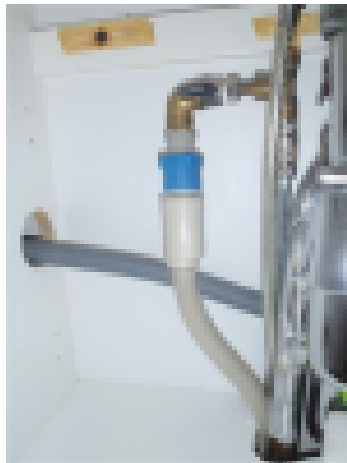
Allaskaapin vuotojäljet ja liitokset tulee tarkastaa
