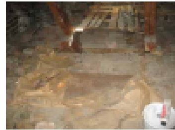
Palopermannon vaurioita kannattaa seurata, alla on usein kosteusvaurio
