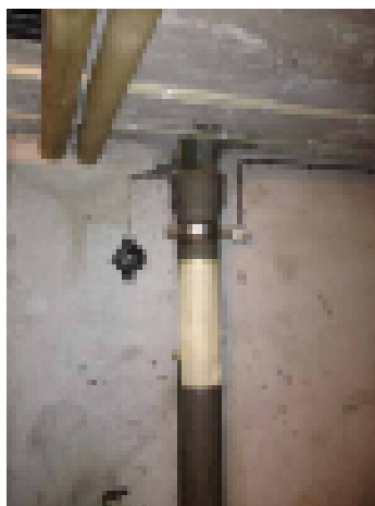
Valurautaviemäriä jo paikattu muovilla
