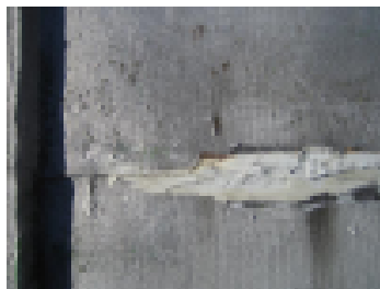
Paikkaukset tehtävä asiallisesti
