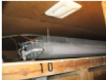
Jäähdytyspatteri levuuttaa kylmää ilmaa tiivistymään rakenteisiin
