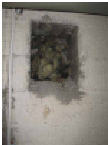
Kellarin raitisilmaventtiili on tukittu
