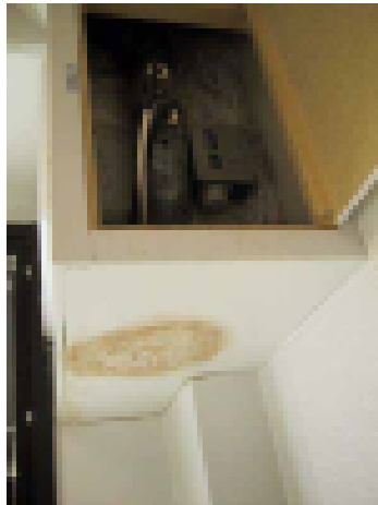
Vesi tiivistynyt rakenteissa
