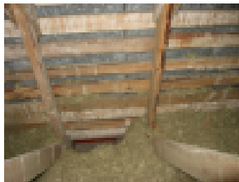
Tukittu räystästuuletus iheuttaa paannejäätä ja vuotoja
