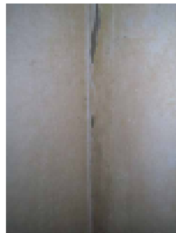
Kuivaushuoneen nurkka homeessa
