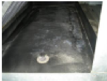
Tuloilmakoneen kammion puhdistus on tärkeää
