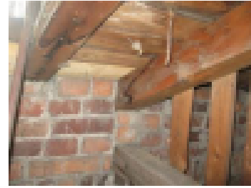
Tuulettumaton räystäs remopntin jäljiltä on suunnittelemattomuuden tulos
