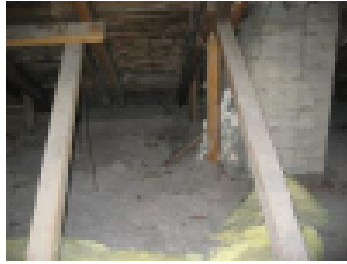
Yläpohjan korjaukset tehtävä kokonaisvaltaisesti
