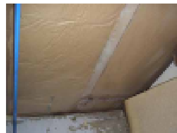
Seinän levytys on vaurioitunut kuivalentakin puolelta
