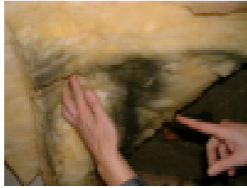
Ilmavuoto näkyy tummentumiona eristeissä ja purut lahoaa
