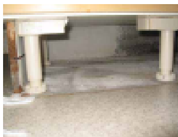
80-luvulla korjatun kellariseinän kosteusvaurio
