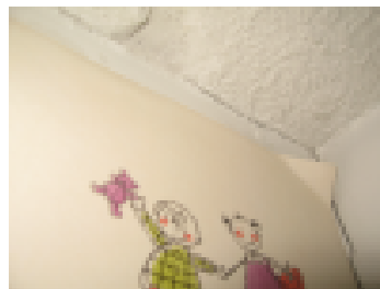
Vesivuoto näkyy ylimmän asunnon katossa, ikkunaseinällä, ellei edessä ole verhokotelo!
