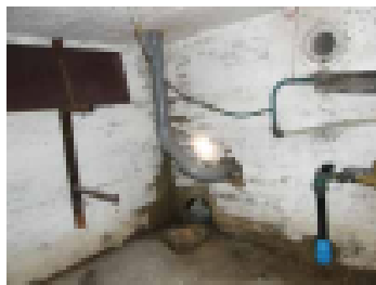
Seinän lävistävät putket usein vuotavat ulkoa vettä kellarin
