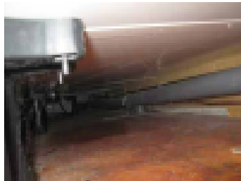
Viemäri kalusteen sokkelissa
