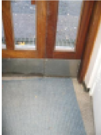
Kosteusvauriot ilmenevät värimuutoksina
