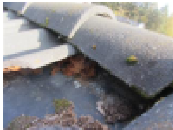
Harjalta vesi pääsee tiilen alta sisään
