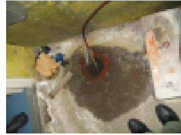
Kylmäkoneen lattiakaivo tukossa
