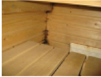
Värimuutokset ilmaisevat kosteusvaurioita
