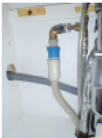
Allaskaapin liitokset tarkastettava. Apk:n poiston mekaaninen kiinnitys
