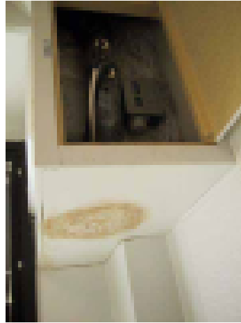
Vesi tiivistynyt rakenteissa
