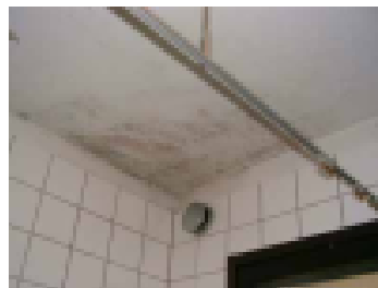
KH ilmanvaihto puutteellinen
