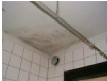
Kattoon tiivistynyt kosteutta puutteellisen ilmanvaihdon takia
