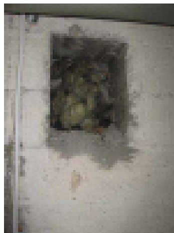
Kellarin raitisilmaventtiili on tukittu
