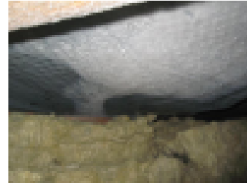
Huurtuminen osoittaa tuuletuksen puutteen
