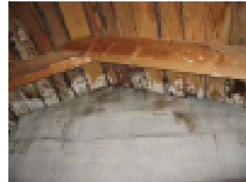
Vesikaton liittymän vaurioita
