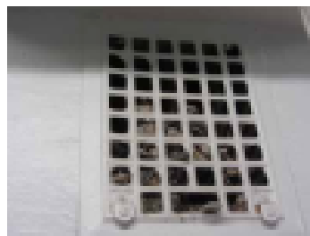
Likainen tuloilmasäleikkö sisätiloissa IMG_3863
