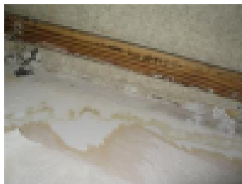
Värimuutokset kuivalla puolella kertovat kosteudesta rakenteissa
