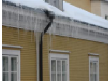
Yläpohjan lämpövuoto aiheuttaa jääpuikot
