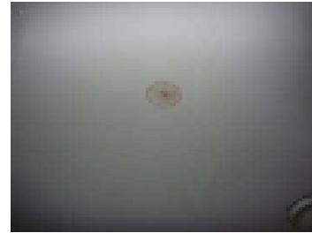
Kosteusvaurio näkyy alakerran katossa
