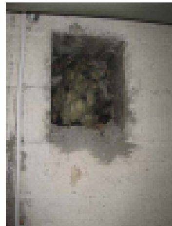
Kellarin raitisilmaventtiili on tukittu
