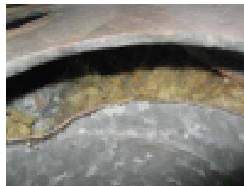
Kanavan vierestä vettä eristeisiin ja asuntoon
