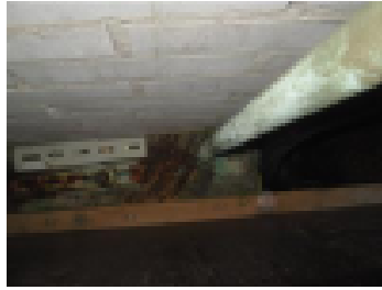
Putkiin tiivistyy kosteutta ja kastelee rakenteita
