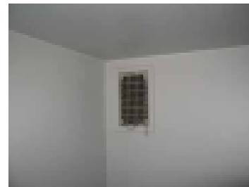
Keittiön poistoilmaritilä tukkeutumassa
