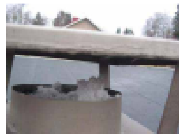
Poistoilma tukittu katolla
