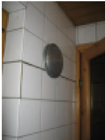
Pesuhuoneen tuloventtiili kylmentää pintoja ja tuo vedontunnetta
