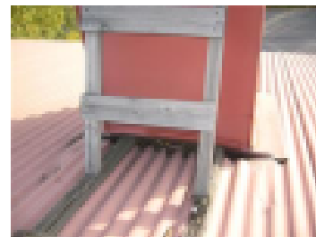
Nuohoojan työskentelylle on tehtävä turvalliset paikat
