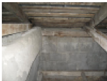
Katon liittymä seinään voi kastella seinää, ellei tuuletus toimi
