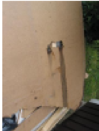
Vuotojälki puretussa kh seinälevyssä
