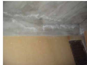
Kosteutta katon rajassa, ilmenee kalkin irtoamisena
