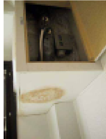
Vesi tiivistynyt rakenteissa
