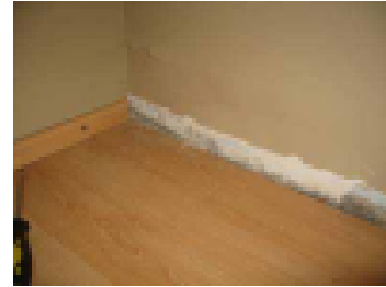
Seinä kastunut toiselta puolelta
