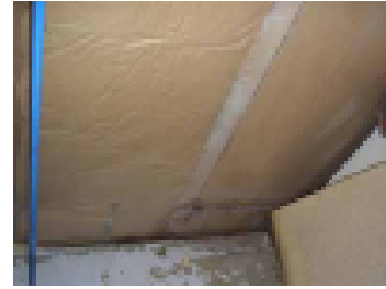
Seinälevytys on vaurioitunut kuivaltakin puolelta
