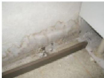
Kosteusvaurio näkyy usein toisella puolella märkätilan seinää
