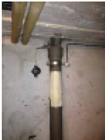
Valurautaviemäriä jo paikattu muovilla
