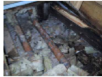
Lattian alta vesivuoto
