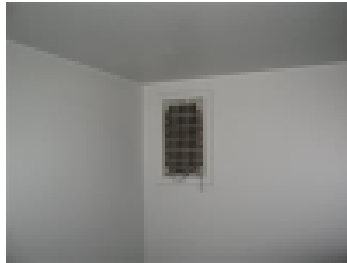
Ritilät ja venttiilit pitää puhdistaa
