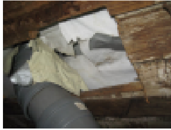
Aluskate on usein rikottu jälkiasennuksissa
