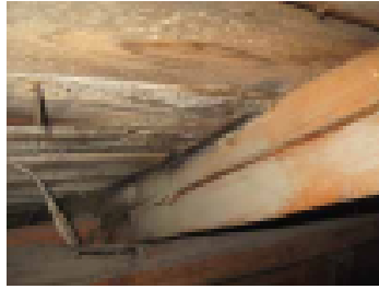
Kattokannattajien liitos seinään voi tiivistää vettä, jos tuuletus räystäällä ei toimi
