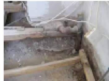
Vanha viemäri välipohjassa
