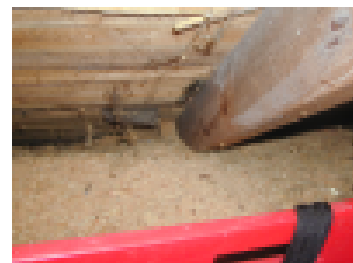
Tuuletusväli on tukossa
