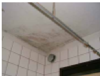
KH ilmanvaihto puutteellinen
