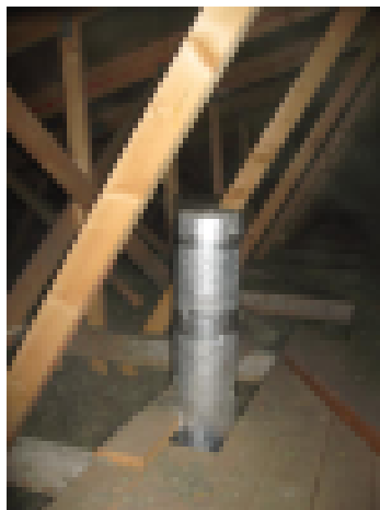
Kesken jäänyt putkitus katolle
