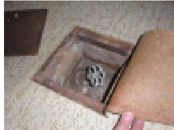
Käytöstä poistettu sulkuventtiili lattian sisällä, puuosat mikrobivaurioituneet
