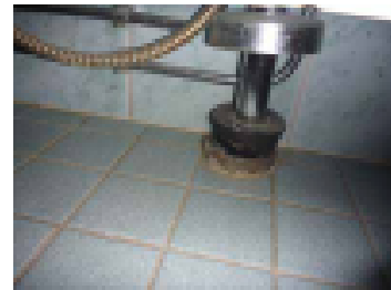
Viemäriin tiiviste irronnut
