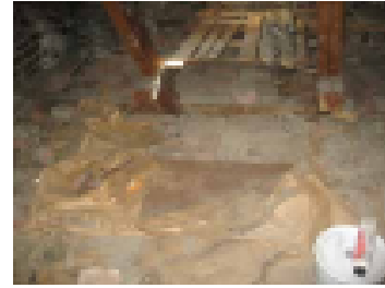
Palopormannon vaurioita kannattaa seurata, alla on usein kosteusvaurio
