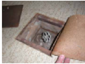
Käytöstä poistettu sulkuventtiili lattian sisällä, puuosat mikrobivaurioituneet
