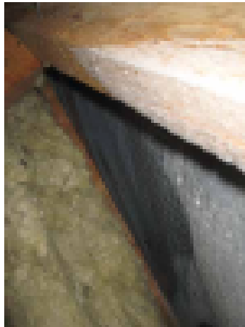
Tuuletustilassa on huono tuuletus ja aluskate jäätyy
