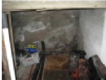
Varastot usein kostuneita ulkopuolisesta vedestä
