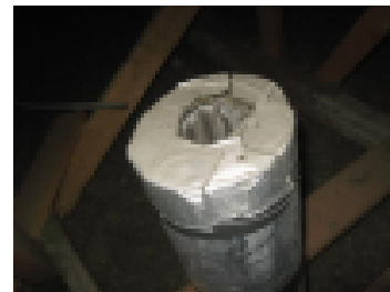
Putki jätetty yläpohjaan kostuttamaan rakenteita
