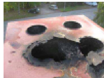
Öljykattilan savu rasittaa piippua ja peltiä
