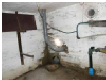
Seinän lävistävät putket usein vuotavat ulkoa vettä kellariin
