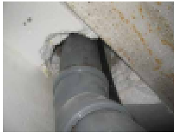
Putken läpivienti on harva ja ilmaapääsee asuntoon
