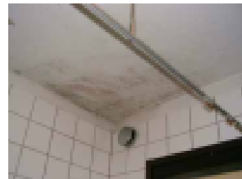
KH ilmanvaihto puutteellinen
