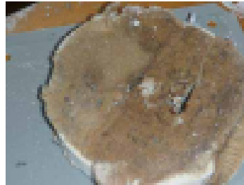
Seinän levytys kastunut
