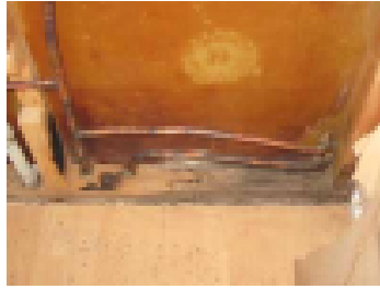
Seinän sisään on tiivistynyt kosteutta eristämättömien putkien takia
