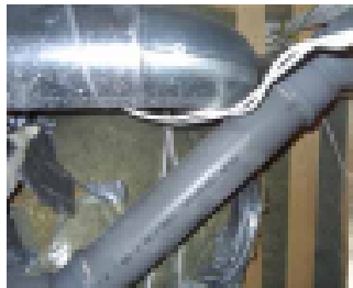
Viemärit risteilevät kotelokatossa
