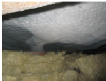
Huurre näkyy pakkasella selvästi, eli ilmavuoto ilmenee helposti
