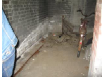
Putket ja liitokset kunnostettava ennen lattioiden korjausta
