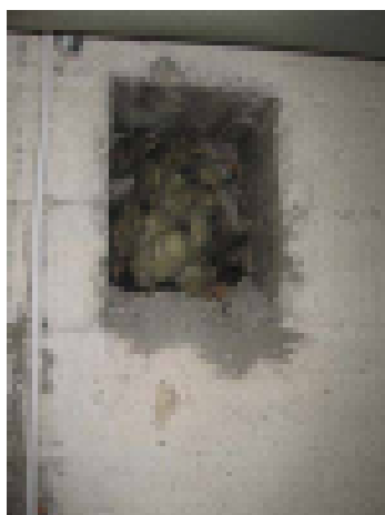
Kellarin raitisilmaventtiili on tukittu
