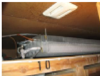
Jäähdytyspatteri levuuttaa kylmää ilmaa tiivistymään rakenteisiin
