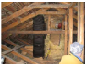
Katon läpiviennit tulee tiivistää huolellisesti myös asunnon puolelta
