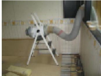
Alipaineimuri vie ilmaa ulos
