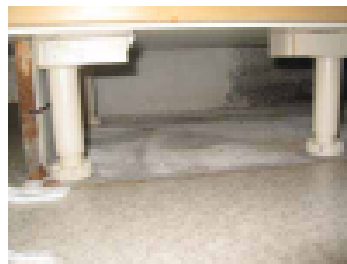
80-luvulla korjatun kellariseinän kosteusvaurio
