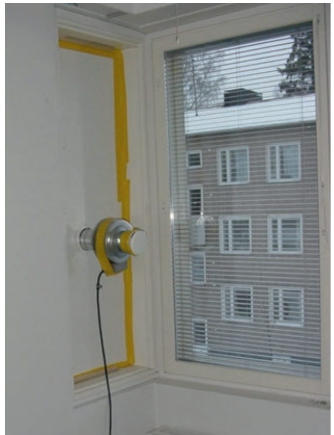
Kuva 4. Ilmanvaihtoa tehostettiin ikkuna-aukkoon sijoitetulla apu-puhaltimella.
