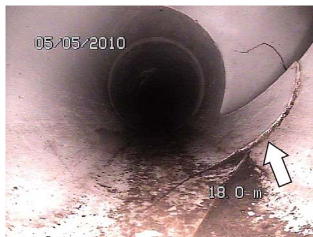
Kuva 34. Viemäriputki on halki t-haran kohdalta putken pohjasta.
