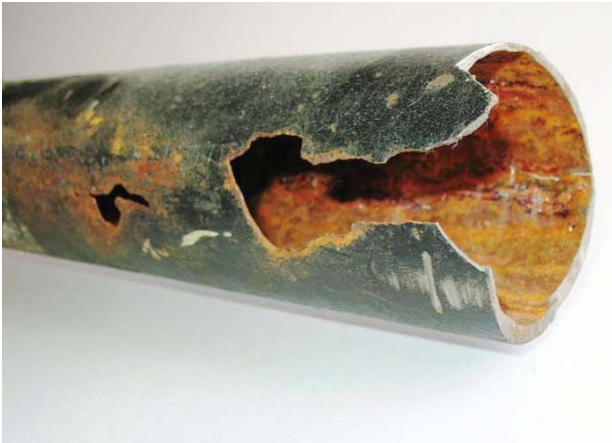
Kuva 50. Huonokuntoinen läpisyöpynyt 1950-luvun valurautaviemäri, jota ei voi sisäpuolelta pinnoittaa eikä sujuttaa.
