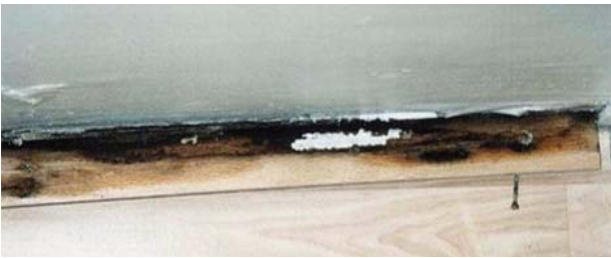
Kuva 14. Kivirakenteisessa väliseinässä kapillaar- isesti nouseva kosteus turmelee seinän alaosan maalipinnoitteita. Irrotetun jalkalistan taustapin- nasta löytyy tällöin yleensä home- tai lahovaurio.
