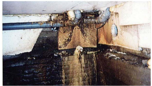
Kuva 15. Viemäri- ja putkivuotoja esiintyy yleisesti rakennusten ryömintätiloissa.
