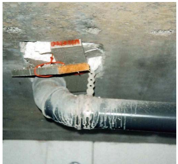
Kuva 16. Ryömintätilan epäpuhtaudet pääsevät puutteellisesti tiivistettyjen putkiläpivientien kautta yläpuolisiin huonetiloihin.
