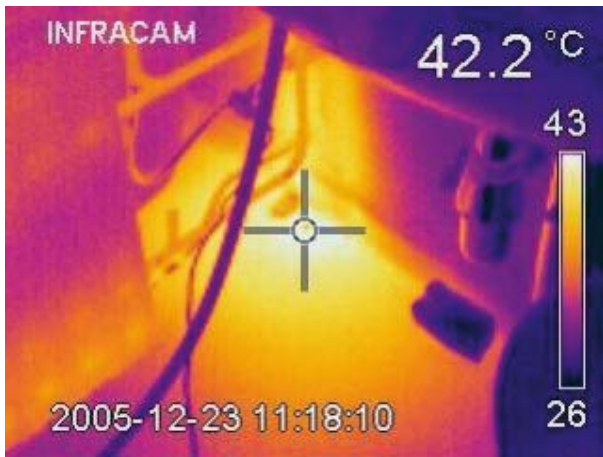
Kuva 30. Lämpökuvaamalla on paikallistettu putkivuoto keittiön lattiaan tiskialtaan alle.
