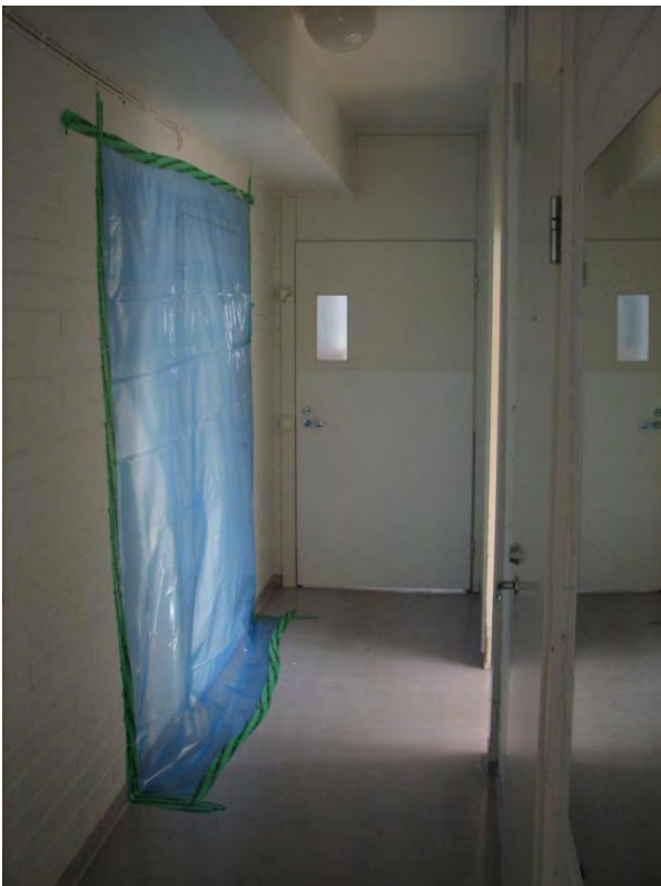
Huoneen C viereistä käytävää. Viereiseen soluun johtava oviaukko on tiivistetty oven takapuolelta.
