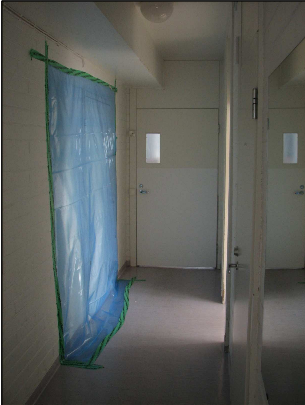
Kuva 33. Siivousvälinevarastoon johtava ovi on tiivistetty 0,2 mm höyrynsulkumuovilla ja huolellisesti teipaten. Ovi sijaitsee huoneen C vierisellä käytävällä. Kuvassa keskellä oleva ovi johtaa viereiseen huoneistoon. Kyseinen ovi on tiivistetty vastaavasti, mutta kuvaajasta katsottuna oven takapuolelta.
