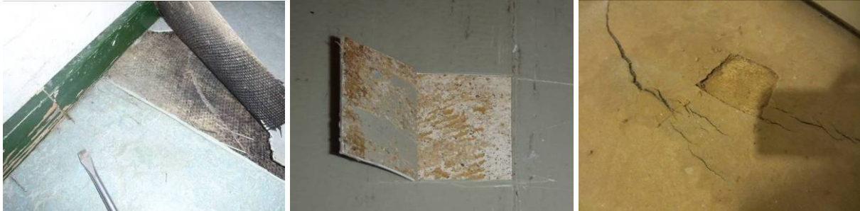
Kuvat 22 a, b ja c. Kuvia päällystevaurioista.
