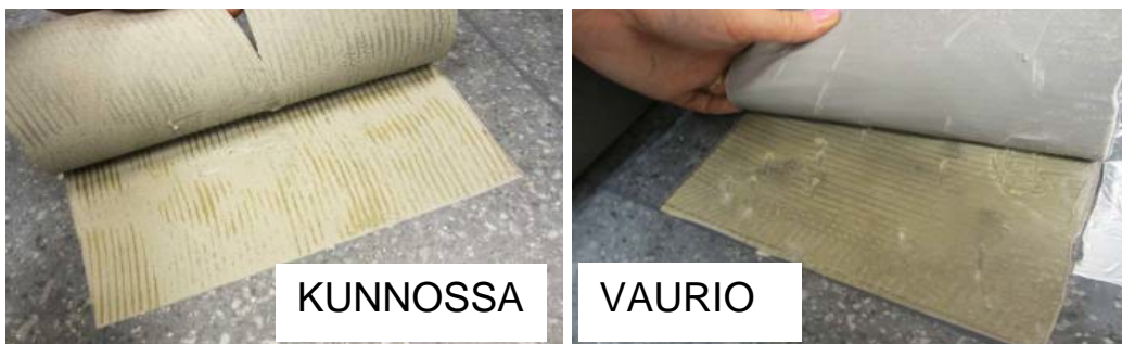
Kuva 23 a ja b. Sama päällystemateriaali samassa kohteessa hyvässä kunnossa olevana ja vauriotuneena.
